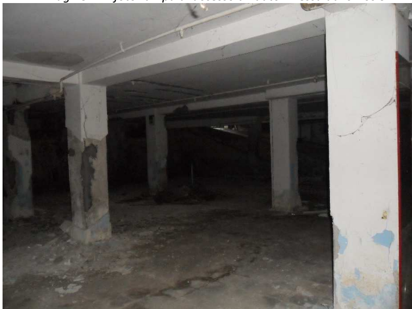
Immagine n.5: foto interno autorimessa con evidenze dei pilastri ammalorati
