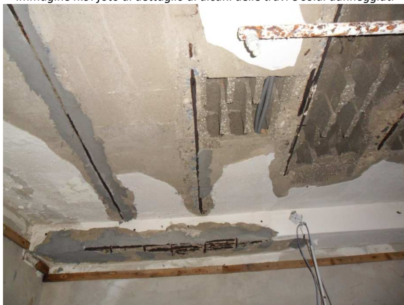
Immagine n.10: foto di dettaglio di uno dei solai ammalorati
