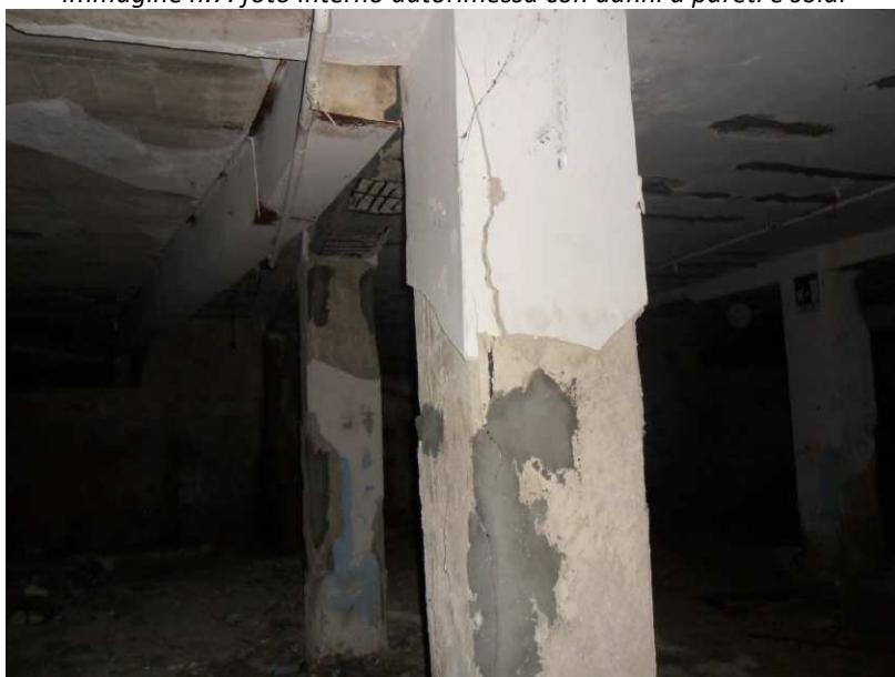
Immagine n.8: foto di dettaglio di alcuni dei pilastri danneggiati
