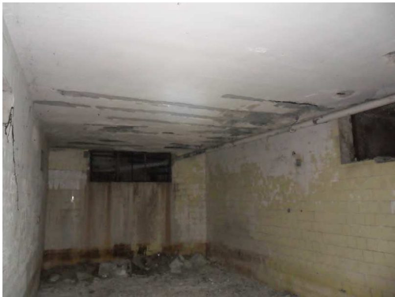
Immagine n.6: foto interno autorimessa con danni a pareti e solai
