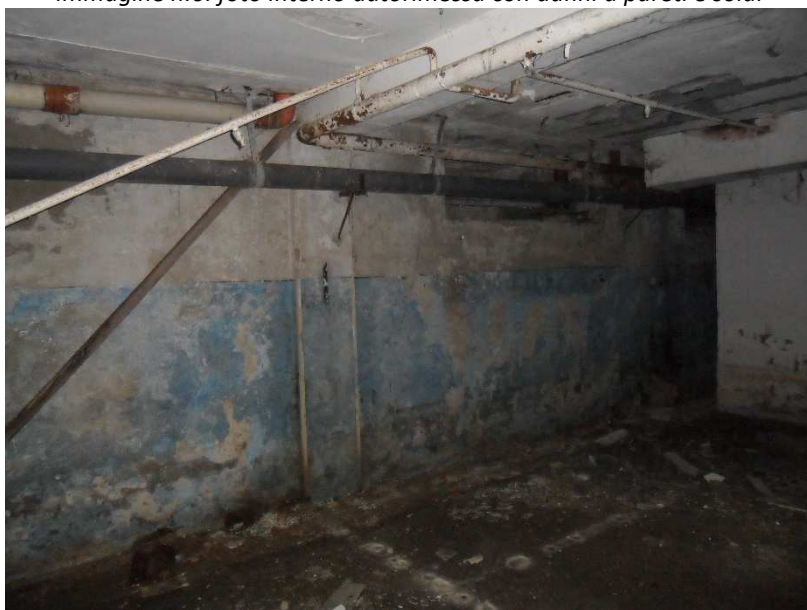
Immagine n.7: foto interno autorimessa con danni a pareti e solai
