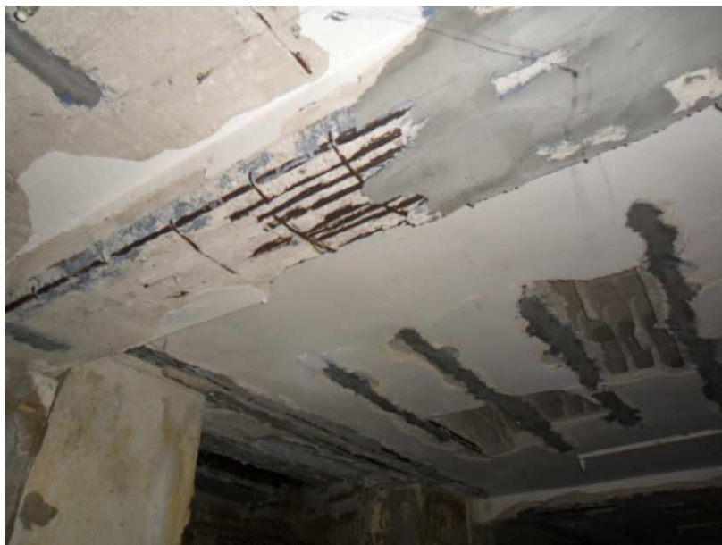
Immagine n.9: foto di dettaglio di alcuni delle travi e solai danneggiati
