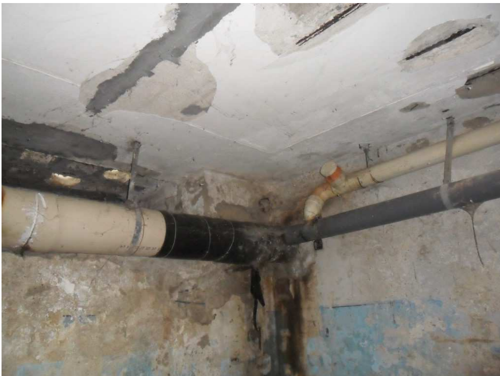
Foto n.13: dettaglio di ulteriori carenze delle tubazioni di scarico condominiali poste sui succieli dell'autorimessa
