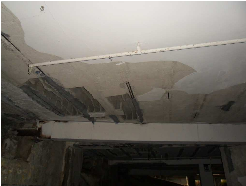
Foto n.9: dettaglio parte di solai danneggiati della autorimessa
