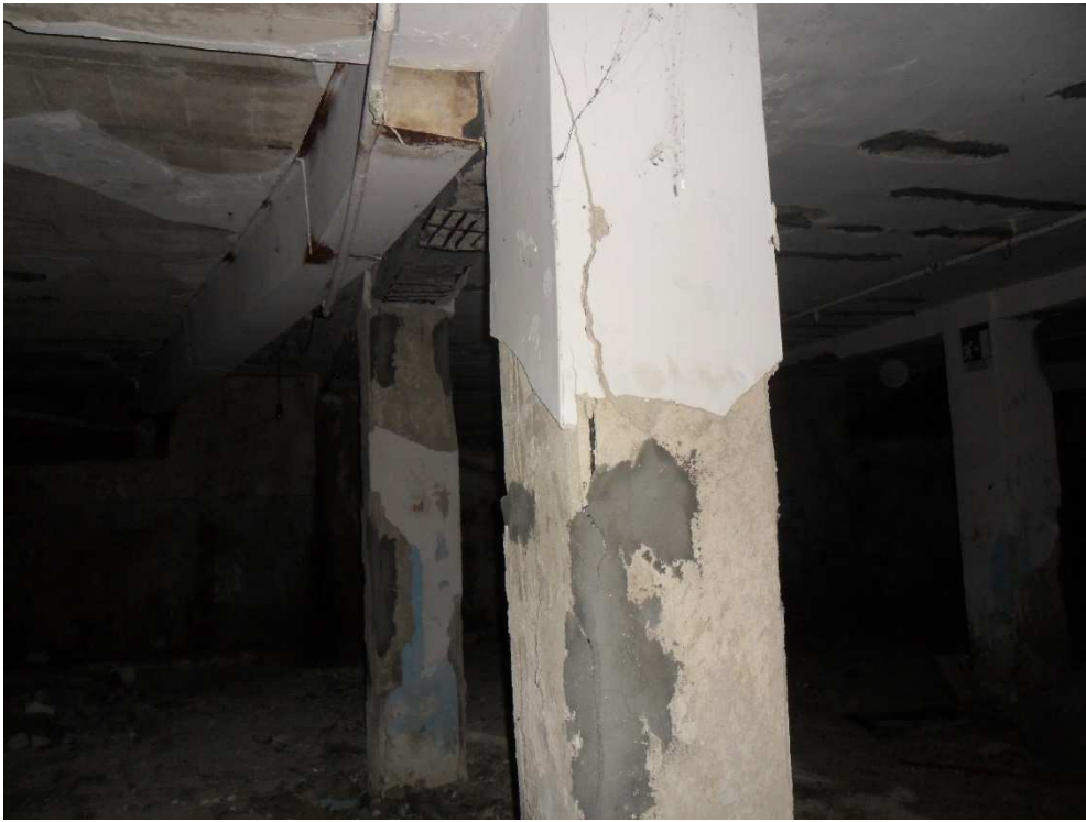
Foto n.10: dettaglio parte di pilastri e travi danneggiate nell'autorimessa
