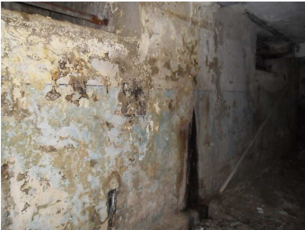
Foto n.11: dettaglio ammaloramento delle pareti perimetrali dell'autorimessa
