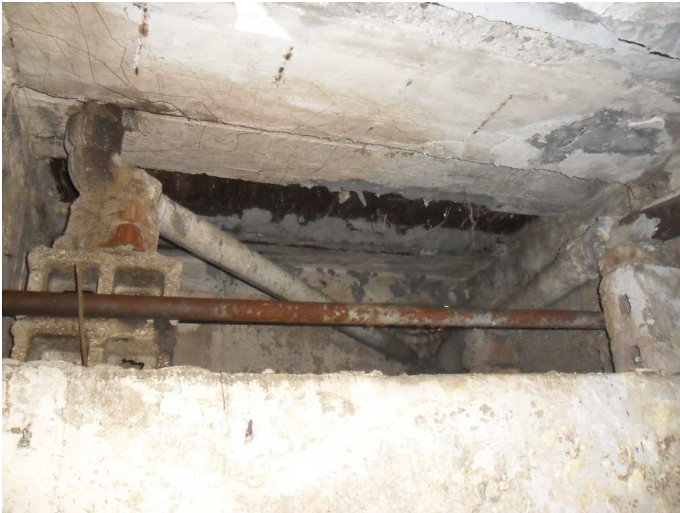
Foto n.12: dettaglio su una delle bocche di lupo della autorimessa con griglia di areazione cementata e carenze delle tubazioni di scarico condominiali
