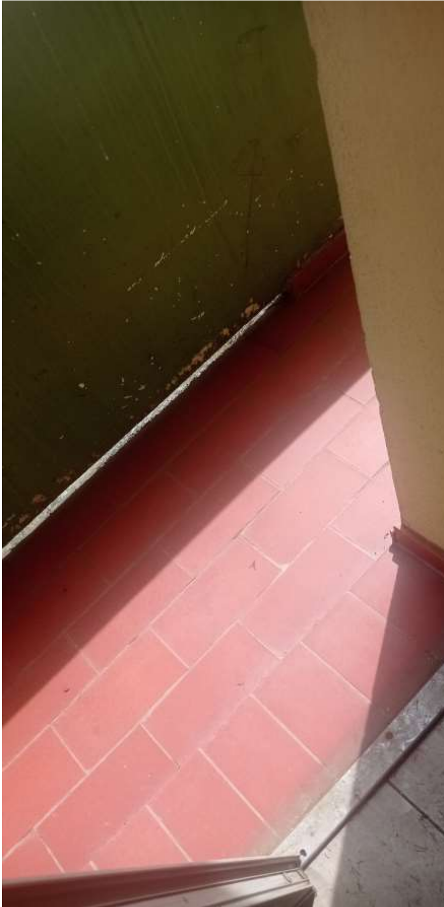
FOTO 21: particolare del terrazzo
