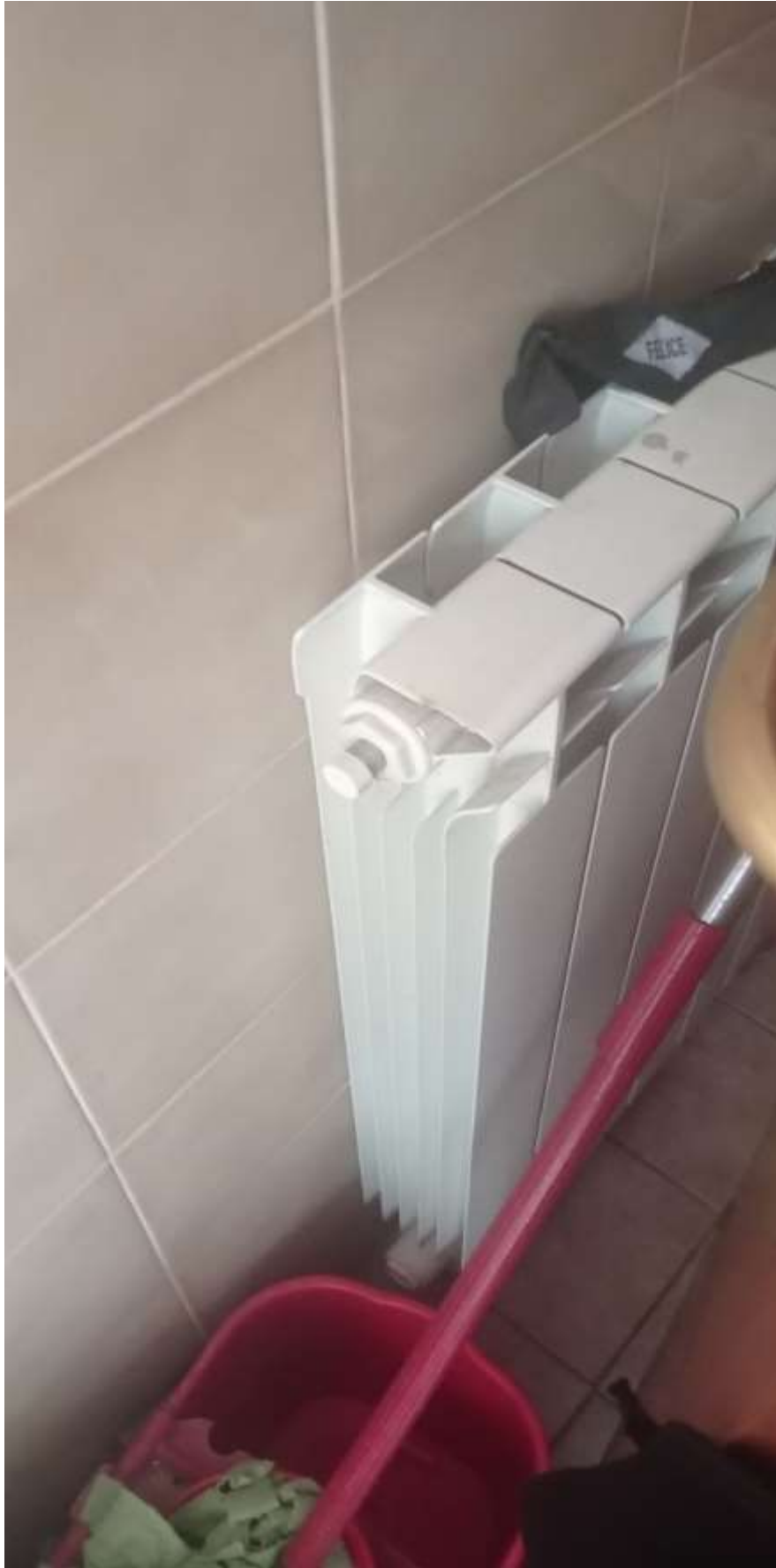
FOTO 24: particolare dei termosifoni
