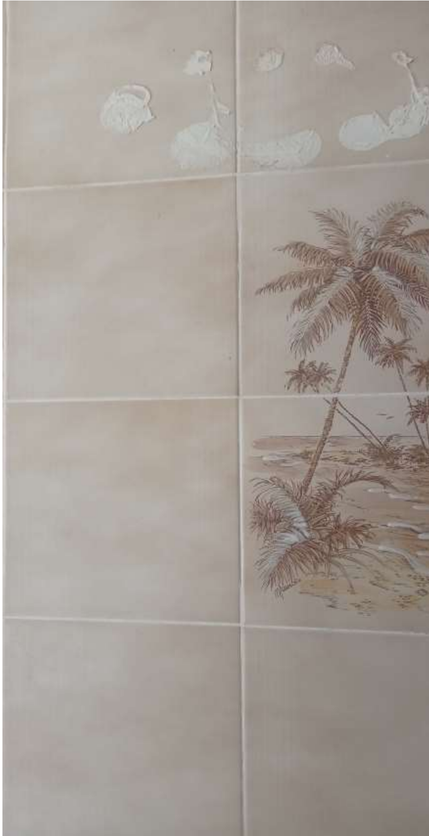
FOTO 25: particolare delle piastrelle di rivestimento del bagno
