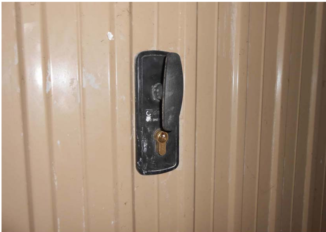
Figura 15 (Serratura sostituita a seguito di accesso coatto)
