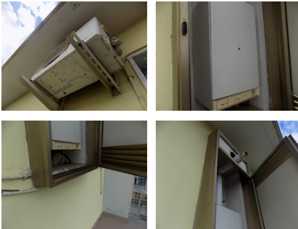
Foto degli ulteriori dettagli di impiantistica all'esterno dell'appartamento
