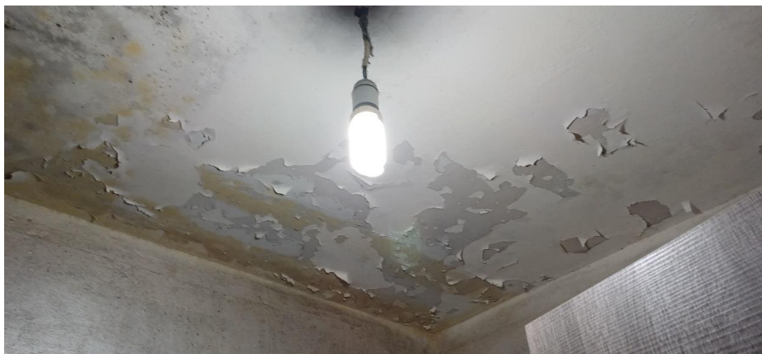
Immagine 14 : soffitto e pareti con umidità bagno 2
