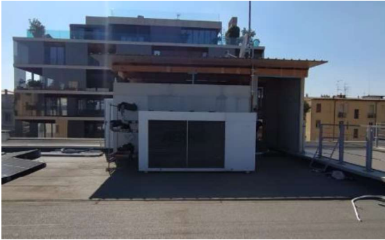
Locale impianti in copertura
