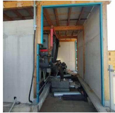
Interno locale impianti in copertura
