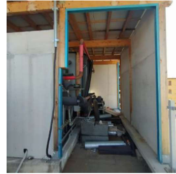
Interno locale impianti in copertura
