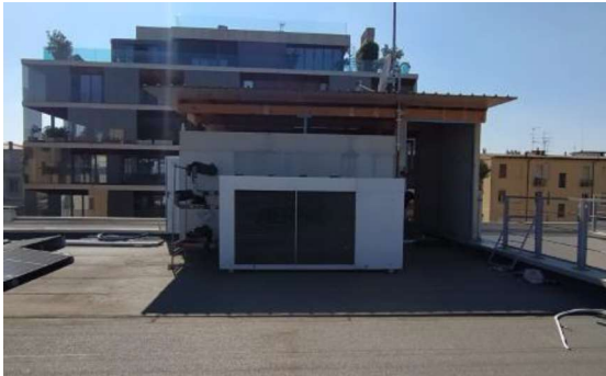
Locale impianti in copertura
