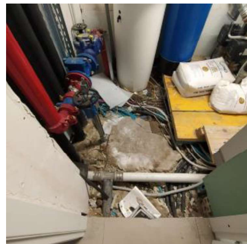
Locali impianti piano terra
