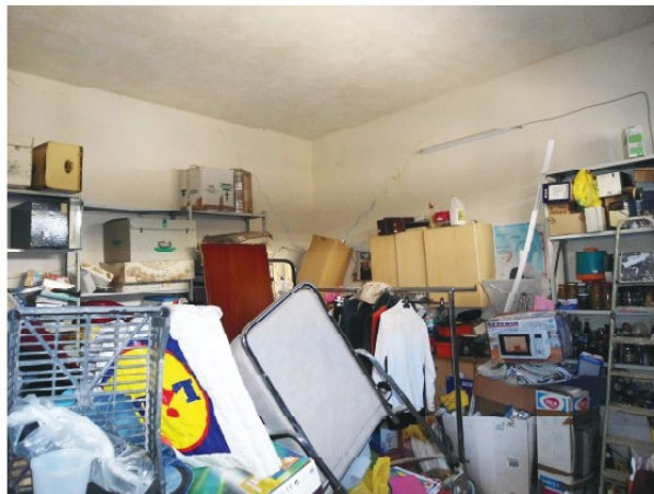
Figura 5. Fessurazione a 45° rispetto all'orizzontale nell'angolo dell'autorimessa
