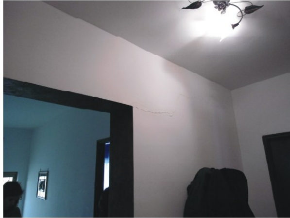
Figura 4. Fessurazione orizzontale nel muro portante centrale
