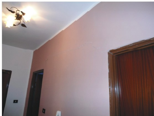
Figura 3. Fessurazione orizzontale nella tramezzatura interna
