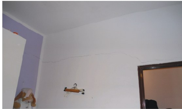
Figura 2. Fessurazione orizzontale nella tramezzatura interna
