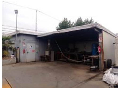
tettoia addossata a cabina elettrica
