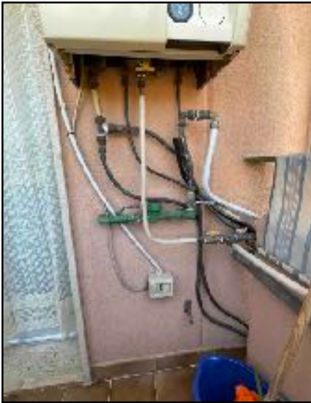
Fig.28 Caldaia sul balcone
