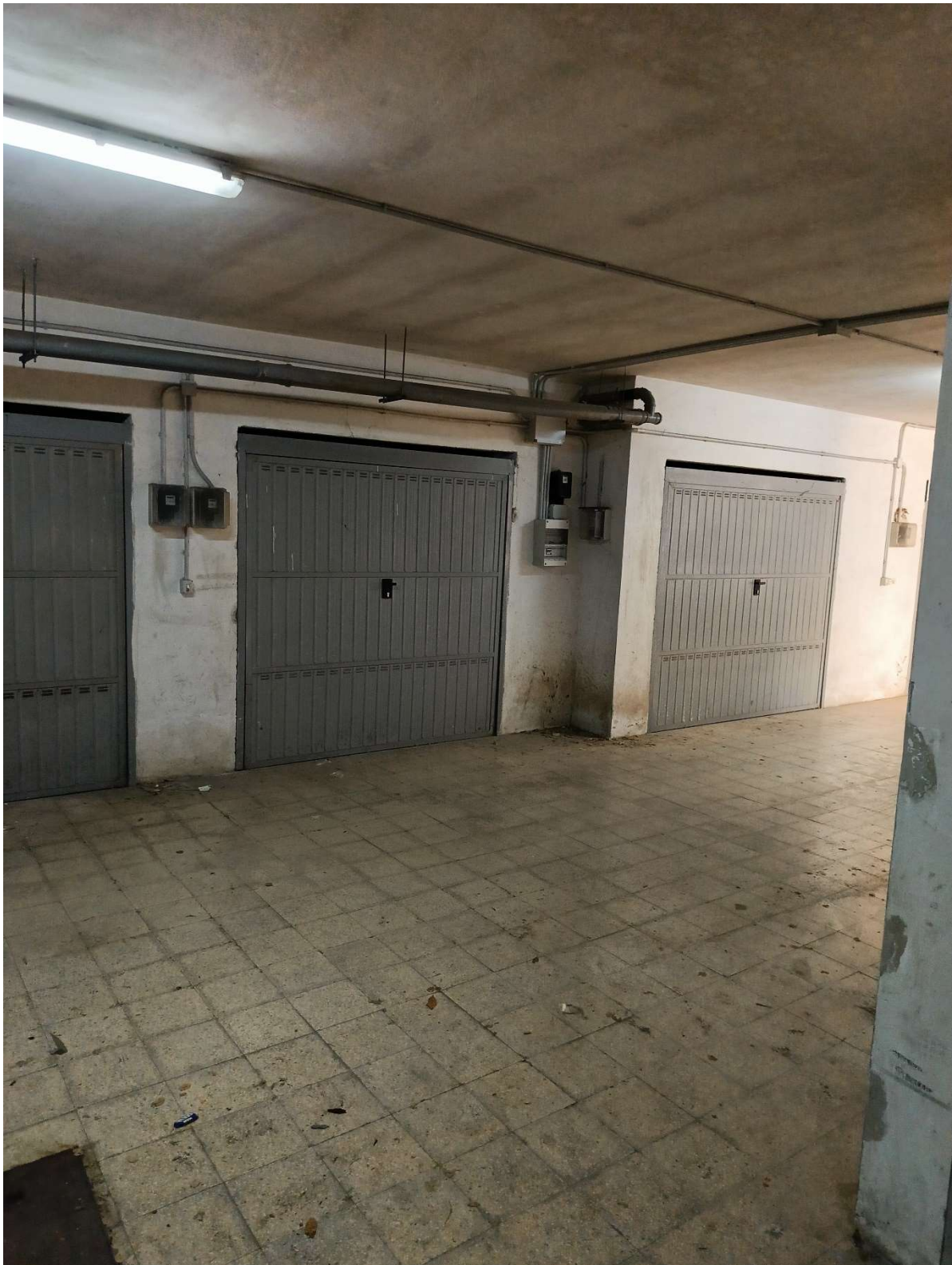
Foto 4 ingresso box sub 11
