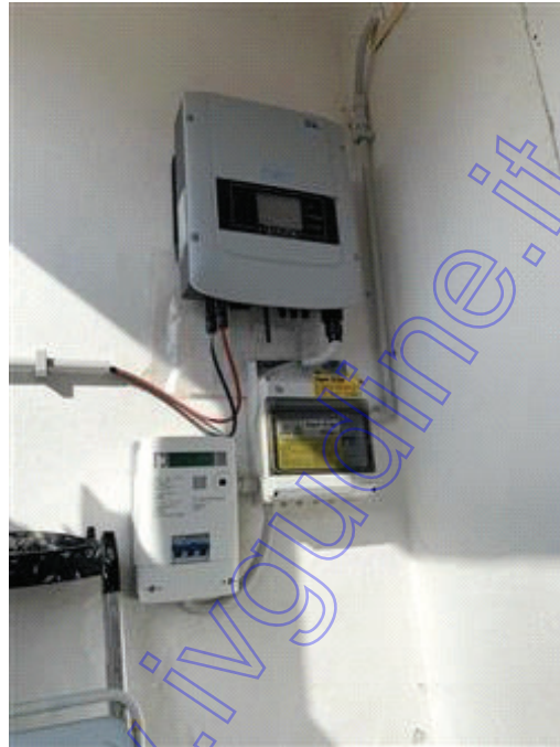
Componenti impianto fotovoltaico posti nella veranda.
