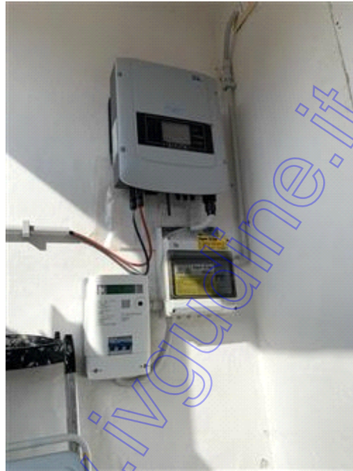
Componenti impianto fotovoltaico posti nella veranda.
