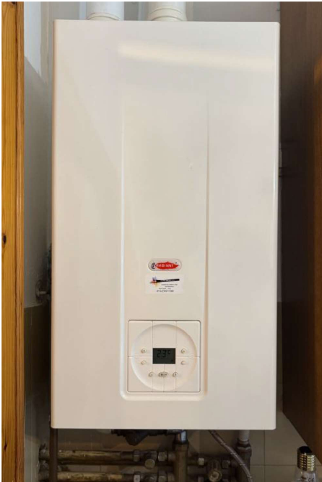
Foto n. 26) vista della caldaia
