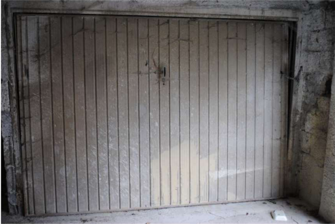
Foto 5 – Porta d'ingresso autorimessa
