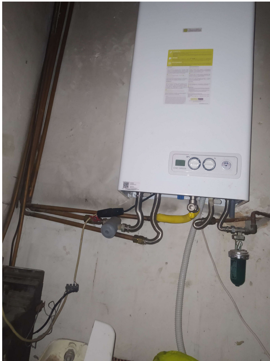
FOTO 12 Caldaia nel ripostiglio (6)
