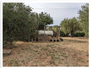
SERBATOIO DI GPL A SERVIZIO DELL'IMMOBILE
