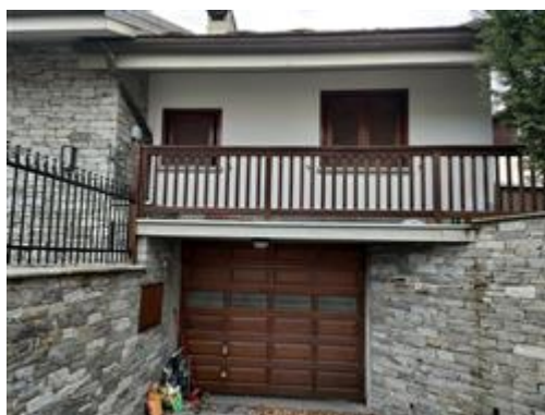
Portone del garage privo del voltino ad arco in pietra.
