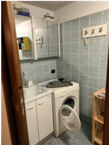
Bagno non autorizzato al piano interrato.
