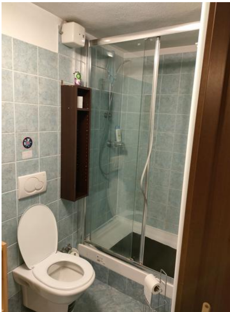
Illustrazione 26: Piano interrato - Bagno ricavato al piano interrato (non autorizzato).
