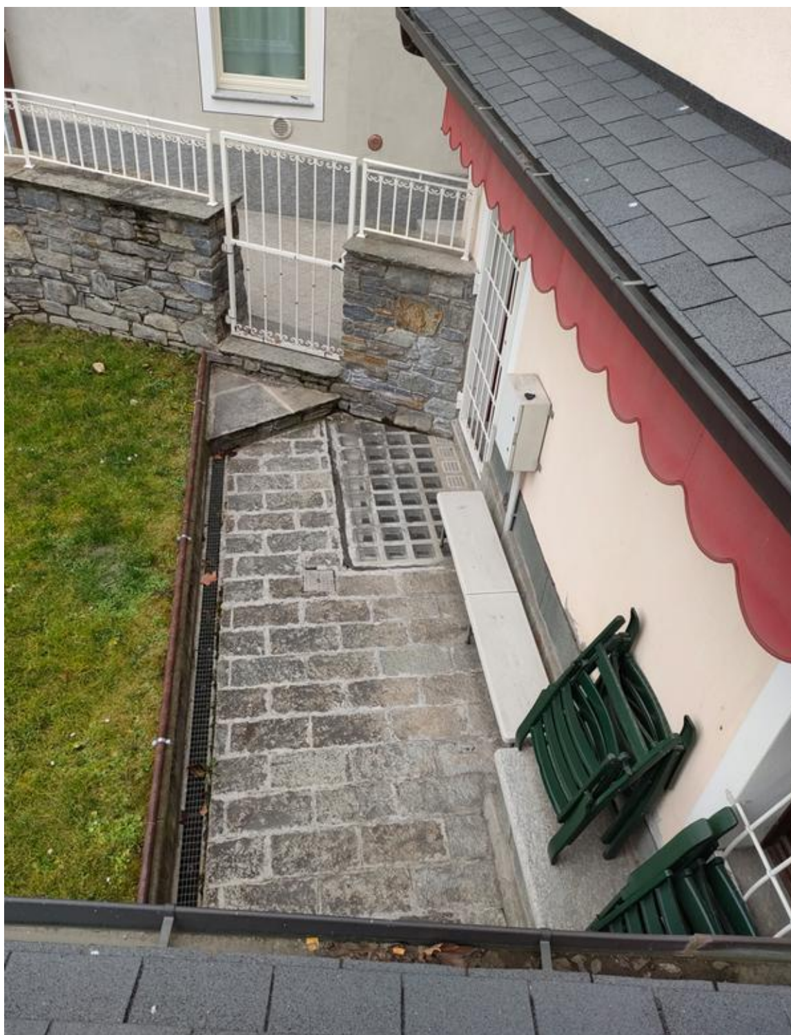
Illustrazione 7: Marciapiede pavimentato in pietra e area verde antistante il fronte est del fabbricato. Vista della bocca di lupo (chiusa con mattoni in vetro-cemento), antistante la porta della camera posta al piano terra, che da luce al locale (non autorizzato) posto al piano interrato.
