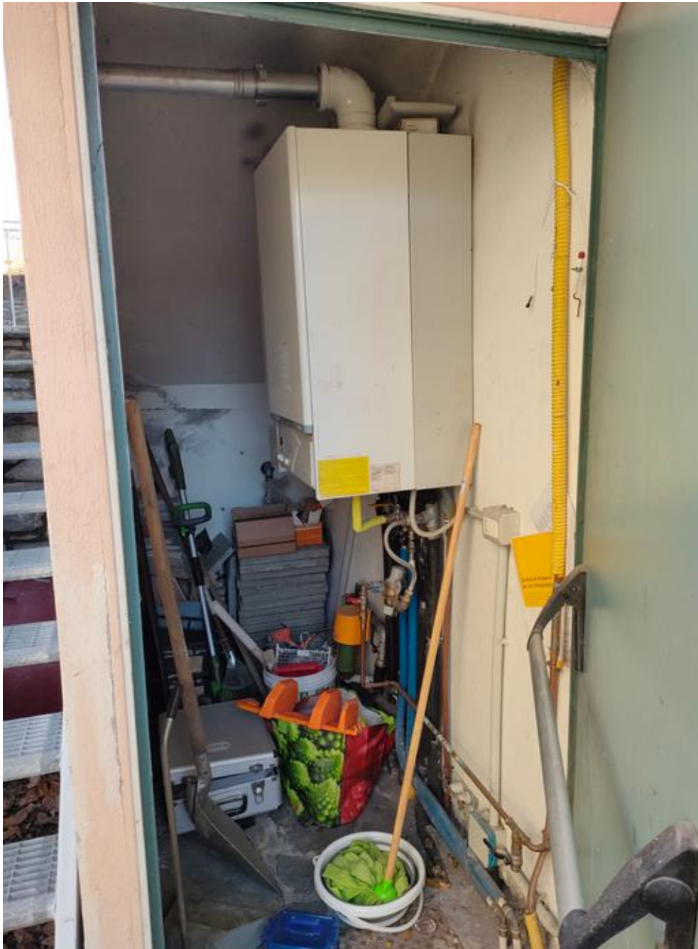
Illustrazione 28: Centrale termica ricavata nel vano sotto scala posto sul fronte nord del fabbricato.
