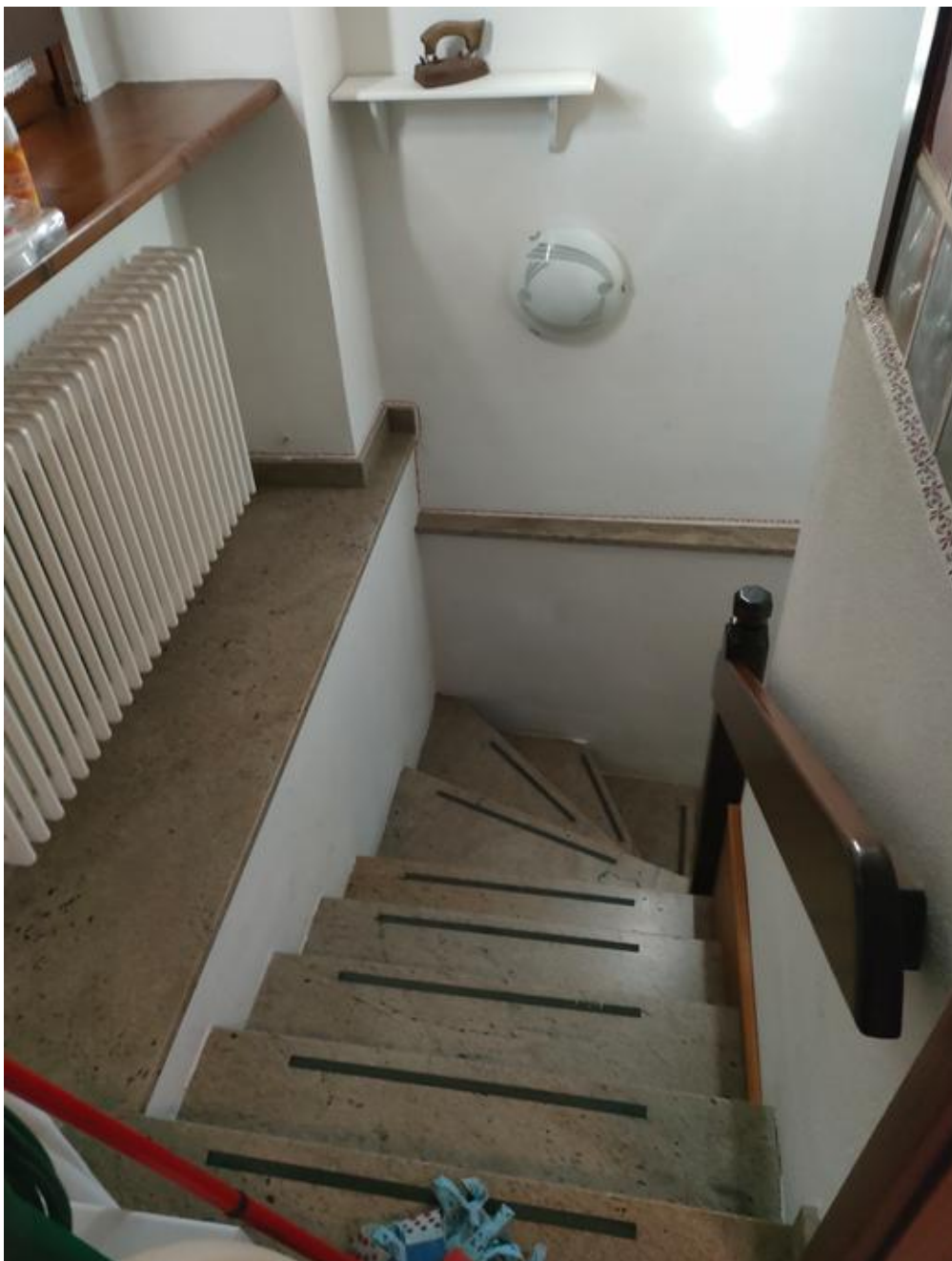
Illustrazione 23: Scala che collega il piano terra al piano interrato (quest'ultimo non risulta essere mai stato autorizzato).
