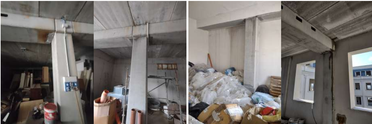
Infiltrazioni nei condotti, nei solai e lungo i pilastri
