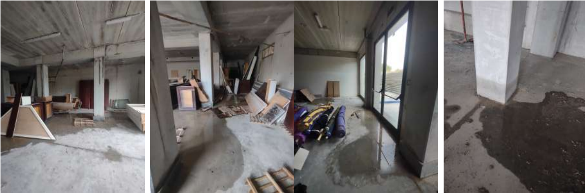
Infiltrazioni d'acqua all'interno del fabbricato con ristagno sulle pavimentazioni
