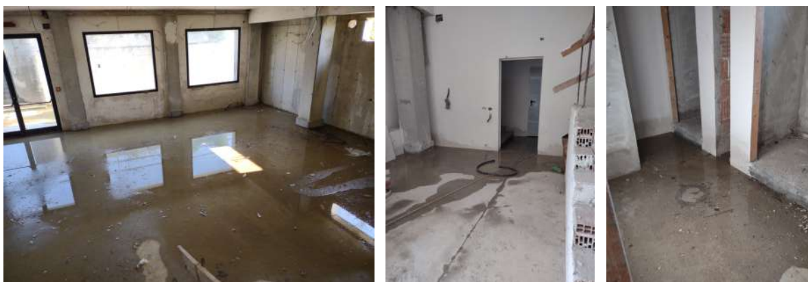
Infiltrazioni d'acqua all'interno del fabbricato
