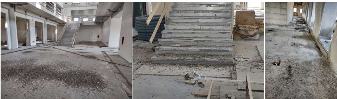
Depositi di guano nei pavimenti e sulle scale
