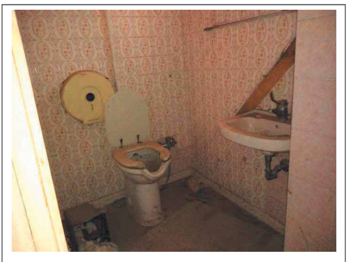
FOTO N. 18 - Bagno zona produzione
