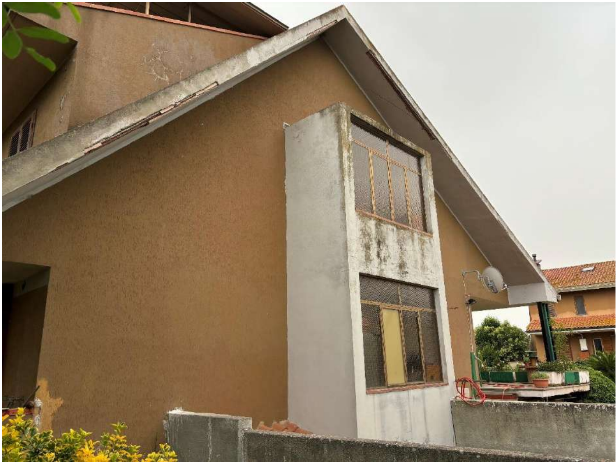
Vista laterale abitazione con veranda zona pranzo e camera 2
