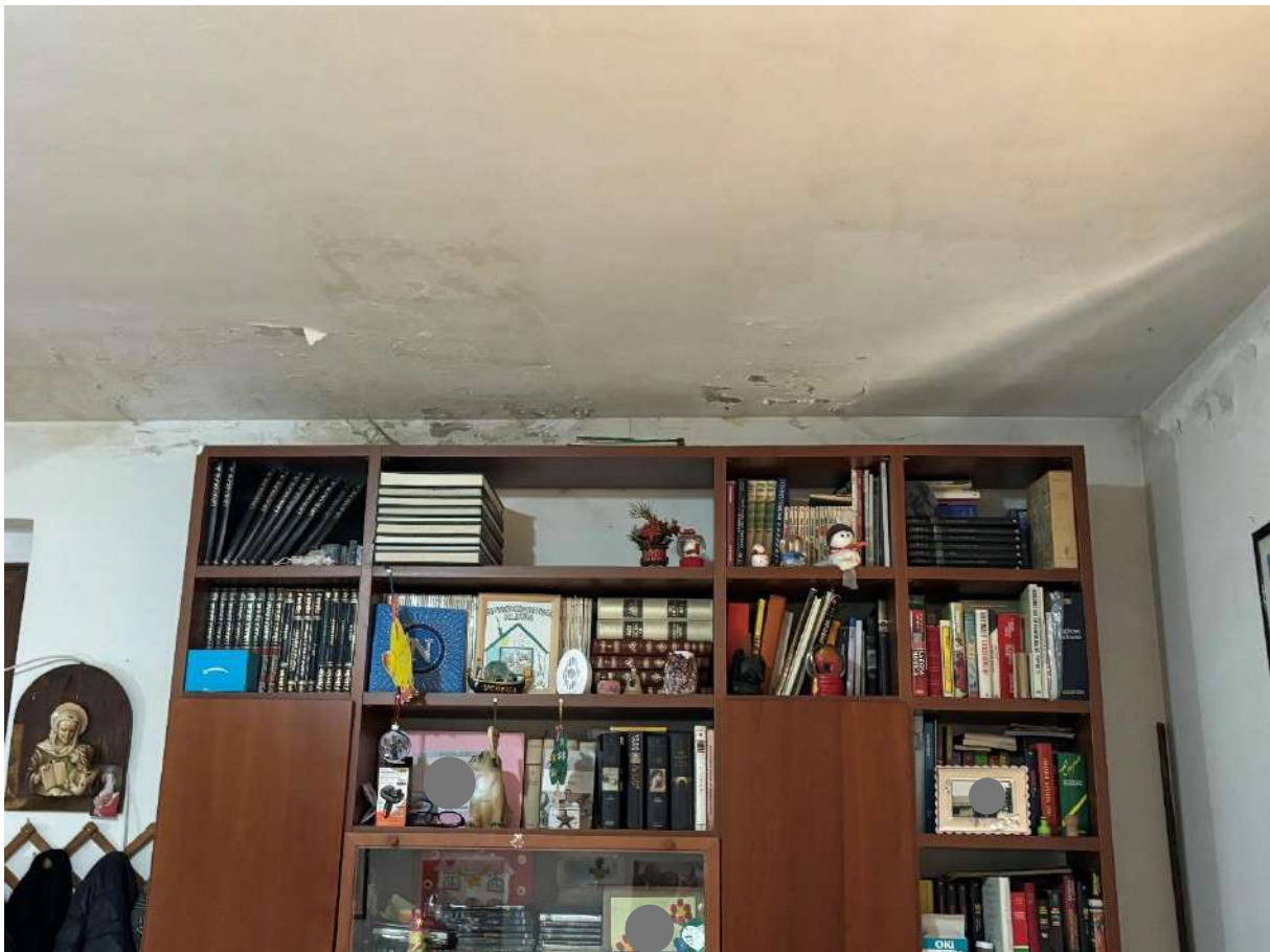
Vista soffitto zona giorno (ammaloramento per probabili perdite idrauliche)
