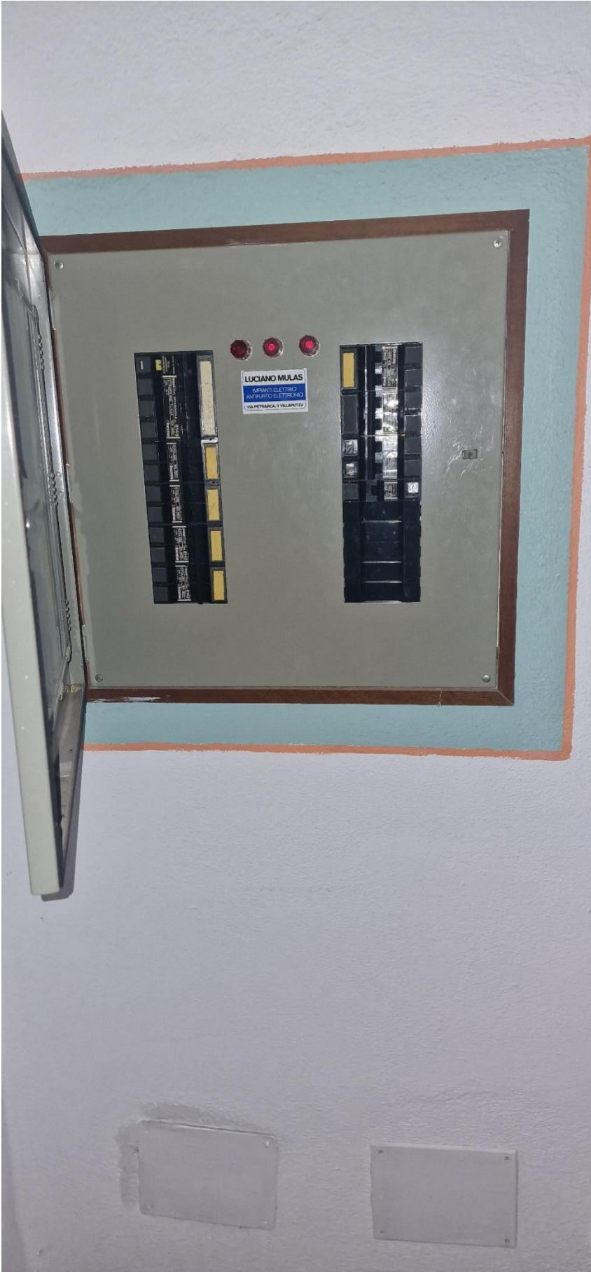
Figura 48 QUADRO ELETTRICO CON DISPOSITIVI DI INTERRUZIONE AMERICANI
