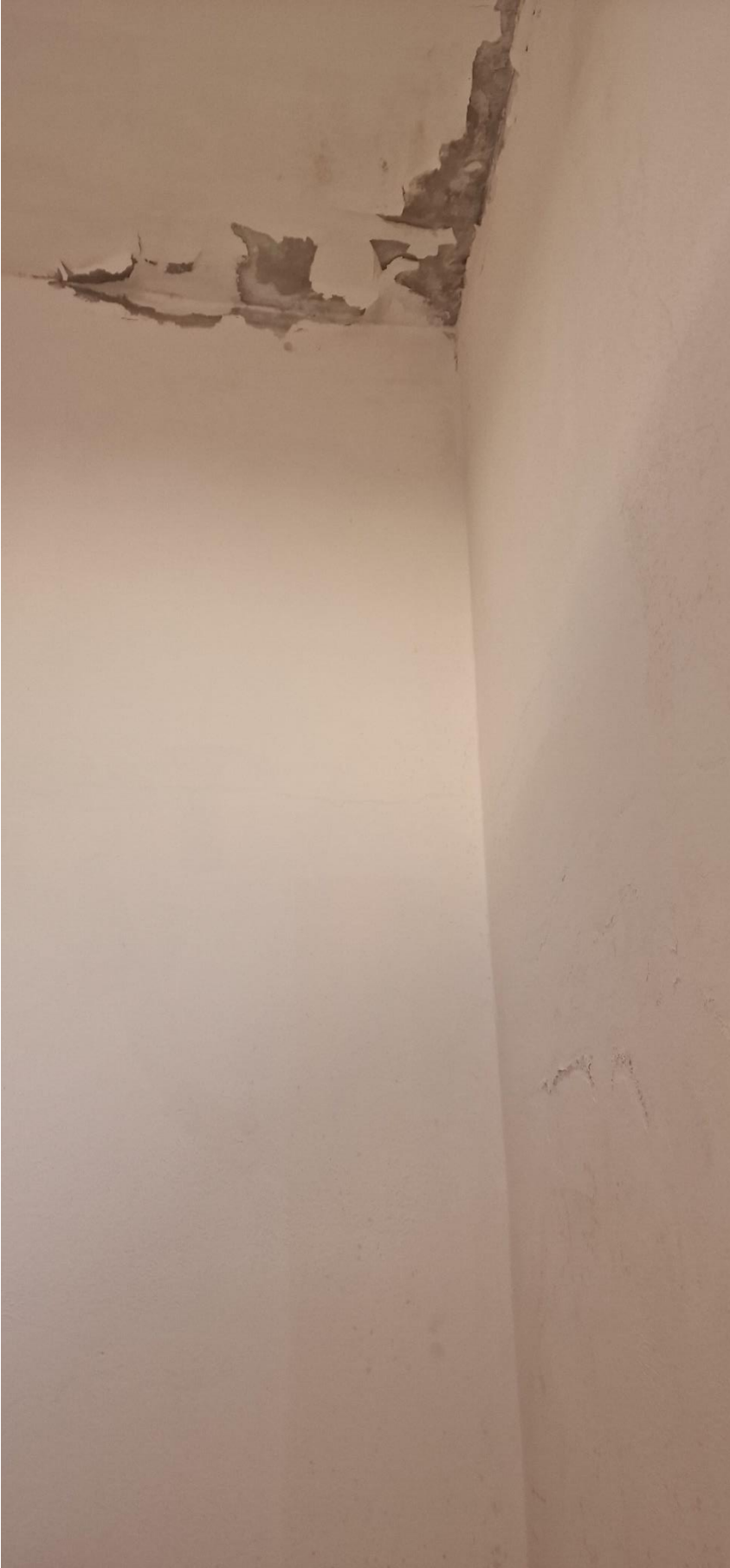
Figura 51 VEDUTA STATO SOFFITTO
