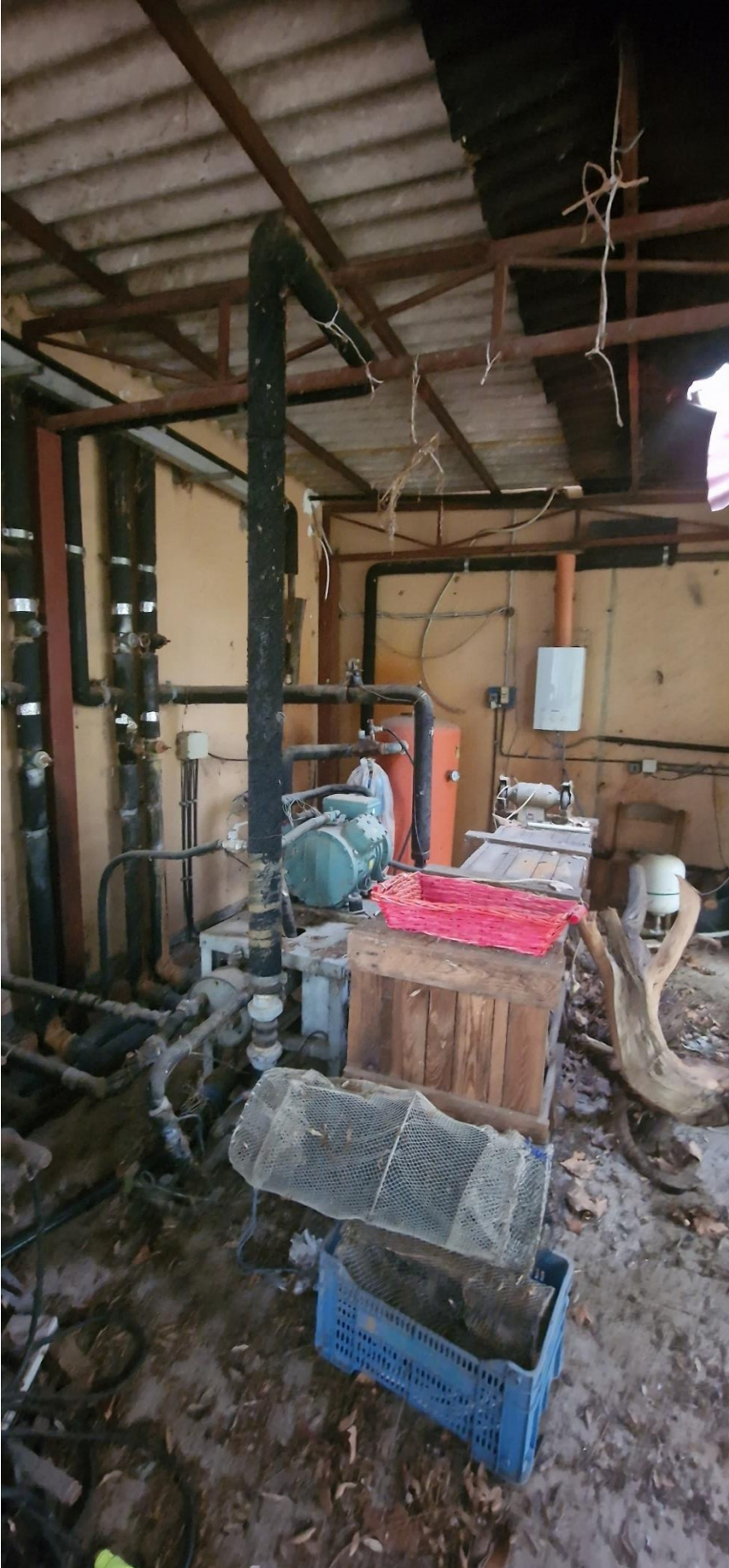
Figura 24 LOCALE TECNICO NON CHIUSO CHILLER
