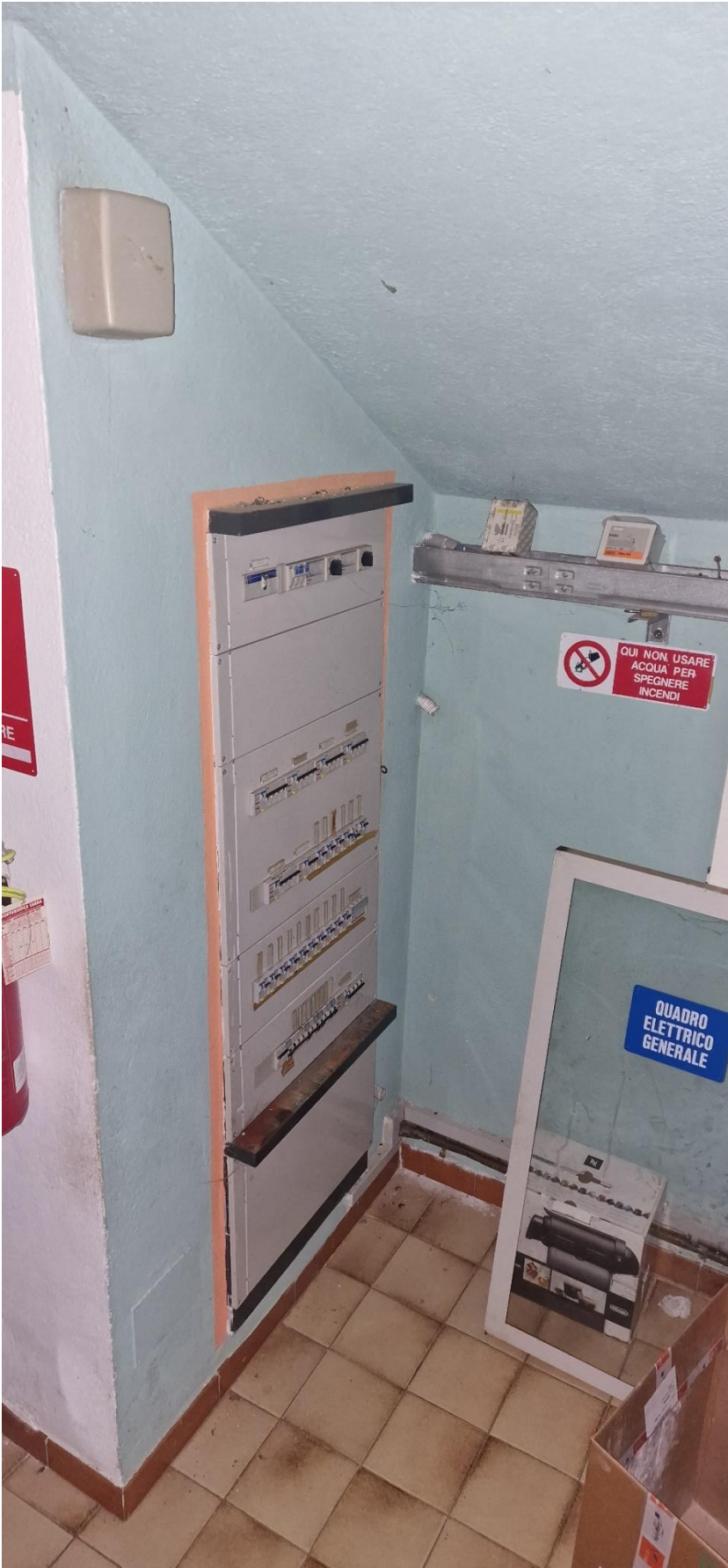
Figura 63 QUADRO ELETTRICO GENERALE
