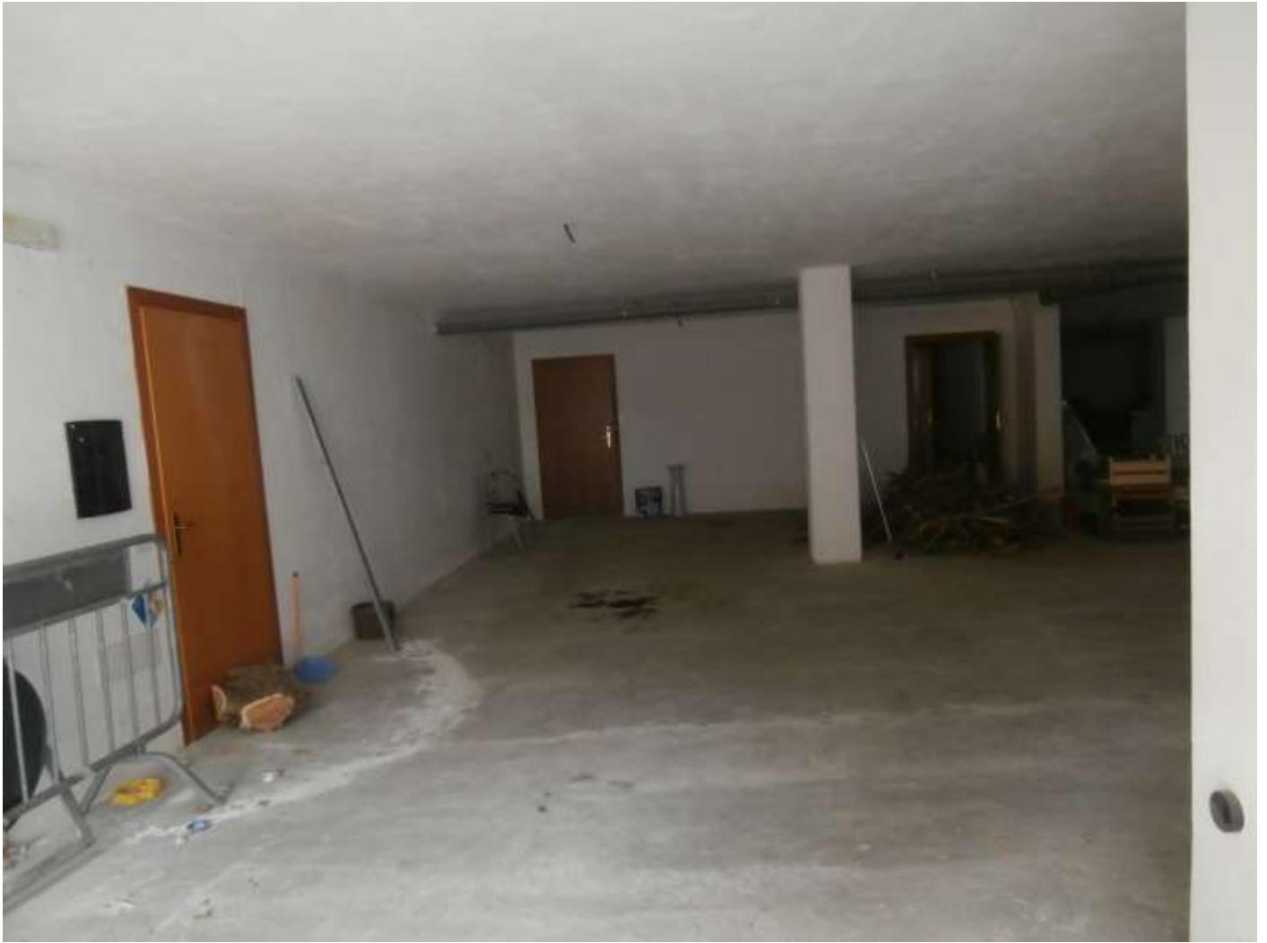
FOTO F.III.1: l'autorimessa lotto III, in evidenza: l'ampia superficie coperta, la struttura in c.a. con pilastri e travi in spessore di solaio, l'impianto elettrico del tipo sottotraccia, i tubi fognari dei piani superiori in pvc a vista con staffe di sostegno, la pavimentazione in massetto di calcestruzzo cementizio spianato con finitura rustica a fratazzo, intonaci a pareti e soffitti del tipo civile.
