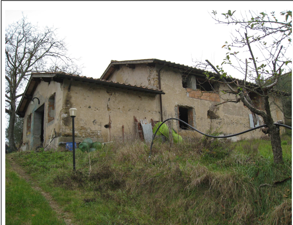
Immagini del fabbricato con evidenza del precario stato manutentivo
