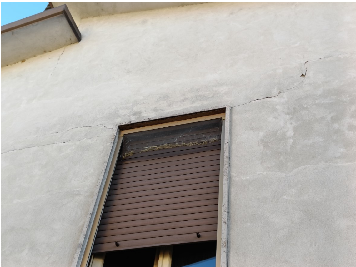
prospetto nord (particolare lesione)
