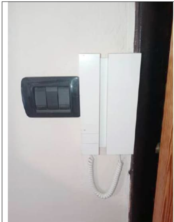
Foto 22. Particolare del sistema citofonico posto all'interno dell'immobile
