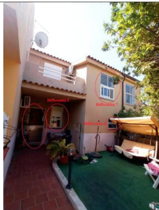
Particolare del prospetto principale attestante lo stato di fatto, dove si possono osservare le difformità rispetto al progetto assentito
