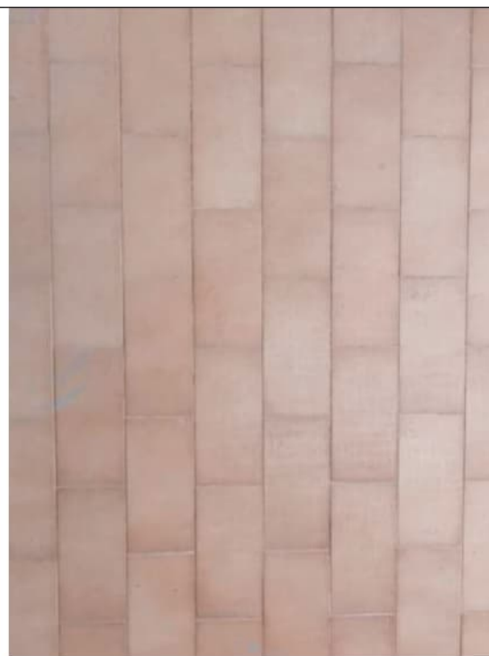
Foto 43. Particolare della tipologia di pavimentazione, in piastrelle di ceramica, presente sul balcone dell'immobile, al piano primo
