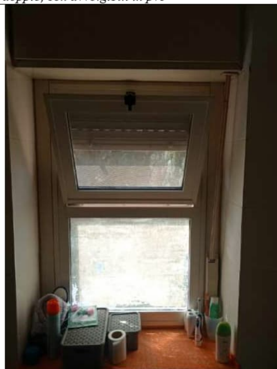
Foto 37. Particolare della tipologia di finestra, ad un'anta, in alluminio, vetro doppio, con avvolgibili in pvc
