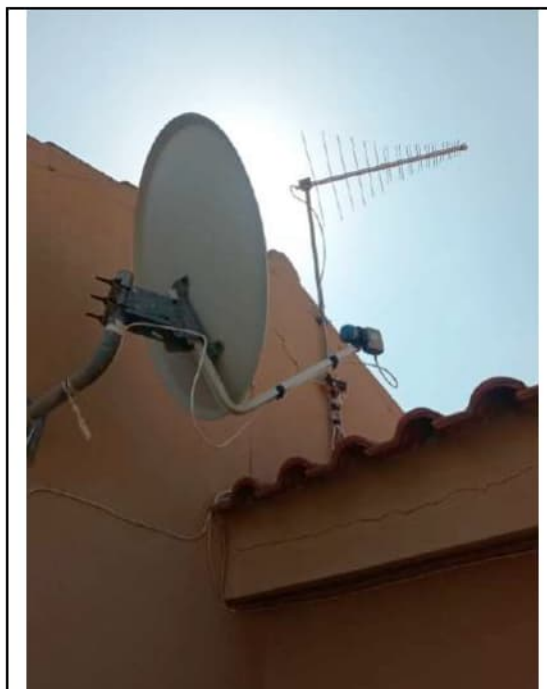
Foto 23. Particolare dell'impianto TV e satellitare
