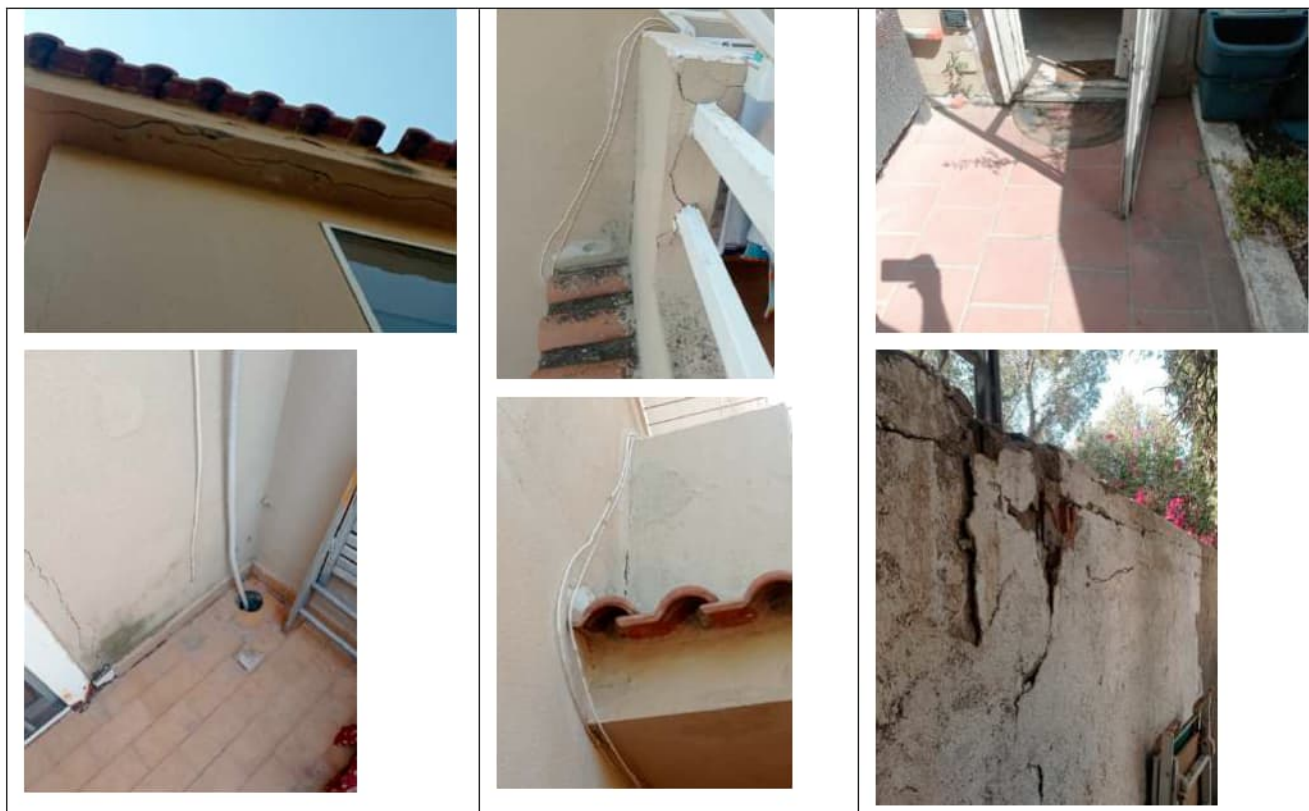
Foto 48. Vista del fabbricato dove si evidenziano problemi legati ad una cattiva manutenzione ordinaria e/o straordinaria, legata al risanamento delle parti ammalorate dal tempo e dalla vetustà del fabbricato, che favoriscono le infiltrazioni di acqua piovana, con conseguente danneggiamento delle componenti edilizie
