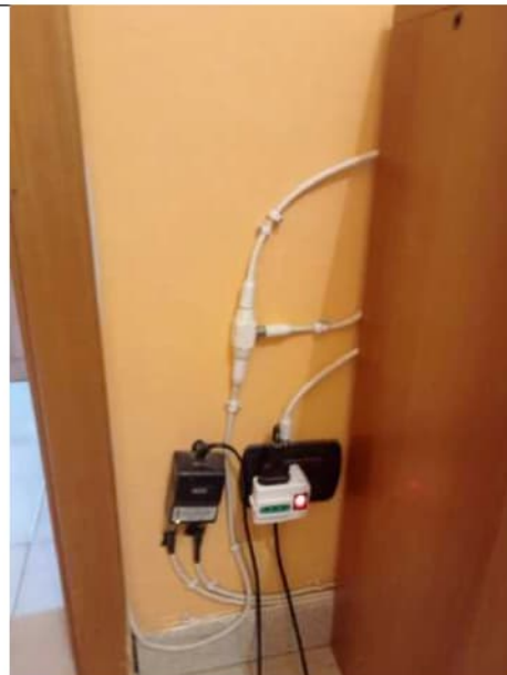
Foto 15. Particolare della tipologia di prese dell'impianto elettrico
