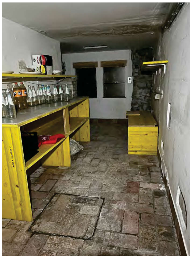
Locale montacarichi al piano interrato
