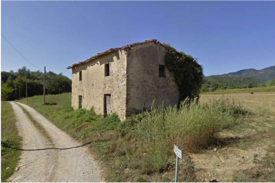
FOTO 27 – Fabbricato diruto (P.Illa 240, sub.1-2)
