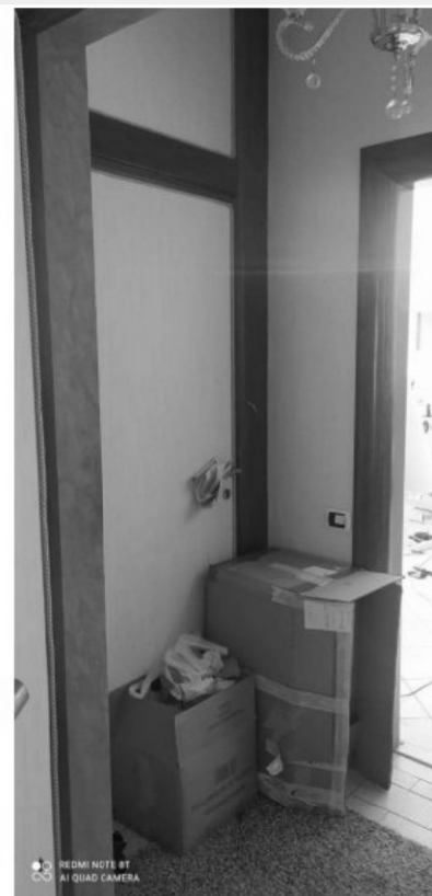
Foto 3 – accesso da scala inibito
