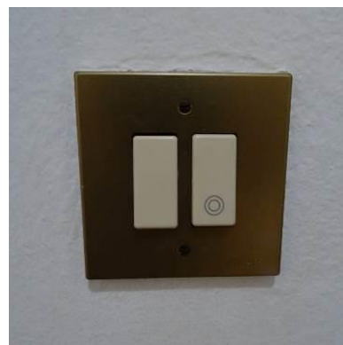
Particolare dell'impianto elettrico.
