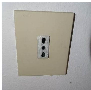
Particolare dell'impianto elettrico.
