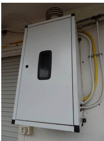
Caldaia a gas per la produzione di acqua calda sanitaria.
