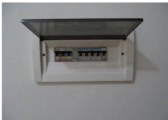
Quadro elettrico dell'appartamento.
