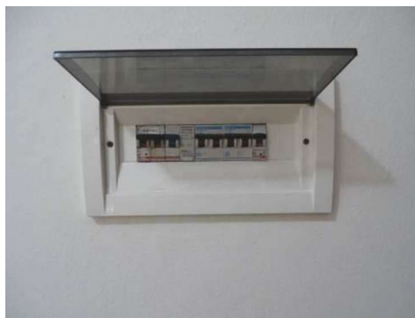
Quadro elettrico dell'appartamento.
