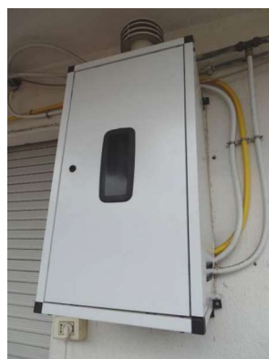
Caldaia a gas per acqua calda sanitaria
