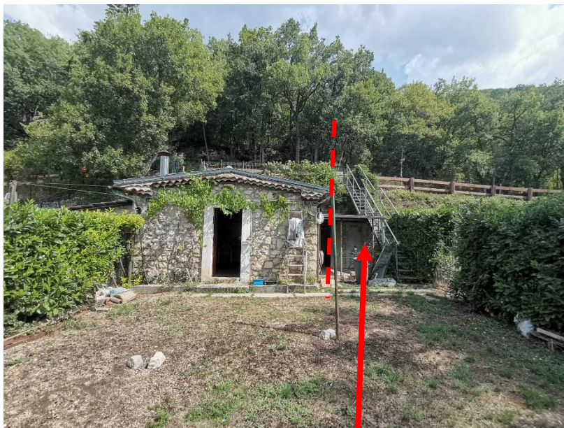
Il fabbricato rurale p.lla 15 aderente ad altra proprietà Parte di questo giardino ricade sulla p.lla 186 (████████)
