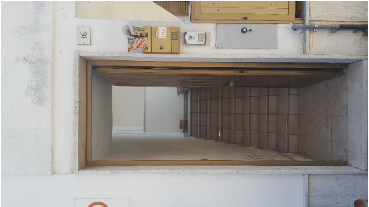
04 - Civico 16 su via Verdi: portone d'ingresso al vano scala di esclusiva pertinenza.
