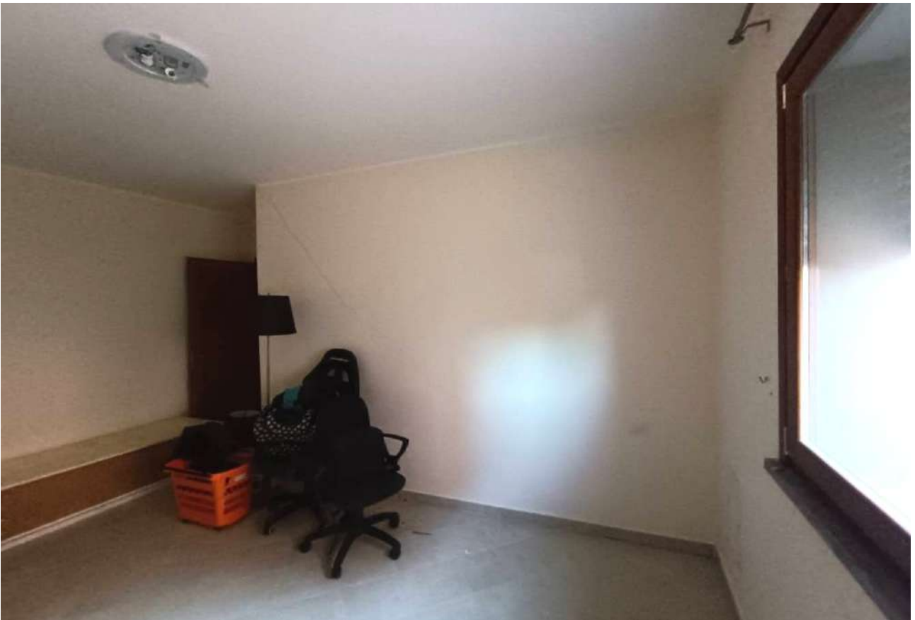
Figg. 20-21 Appartamento Sub. 98 Int. D/4 PT - Camera matrimoniale con affaccio su corte/giardino (visibili fessurazioni sui rivestimenti tramezzo)
