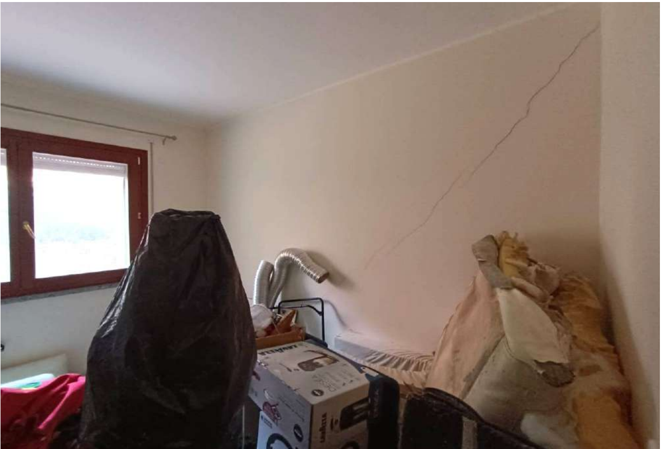
Figg. 22-23 Appartamento Sub. 98 Int. D/4 PT – Camera/Studio con affaccio su corte/giardino (visibili fessurazioni sui rivestimenti tramezzi)
