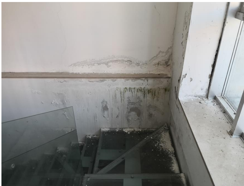
FOTO 15 – deterioramento murature e pilastri zona ingresso sub. 52 e scala sub. 50
