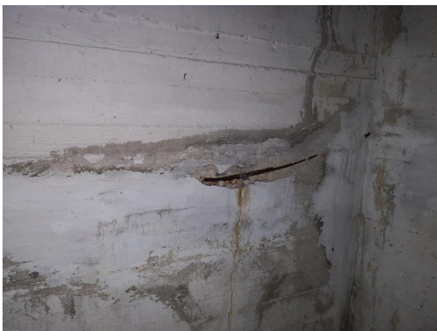
FOTO 16 – parti di zone deteriorate magazzino sub. 54
