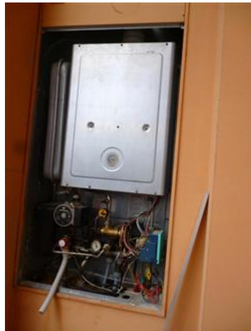
Caldia a gas-metano zona balcone
