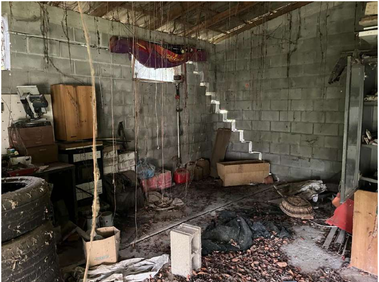
Fabbricato abusivo con particolare criticità
