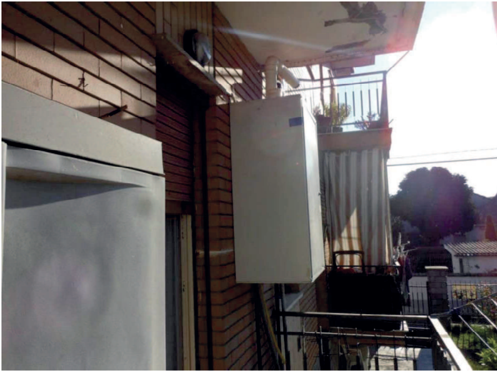
Foto 19 Caldaia su balcone alloggio mapp.851 sub.1 p.r.
