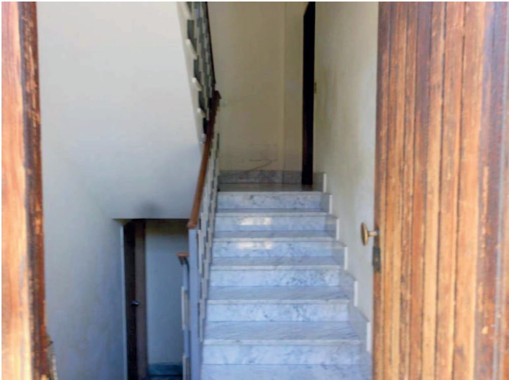
Foto 9 Vano scala comune accesso unità mapp.851 sub.1 p.r.
