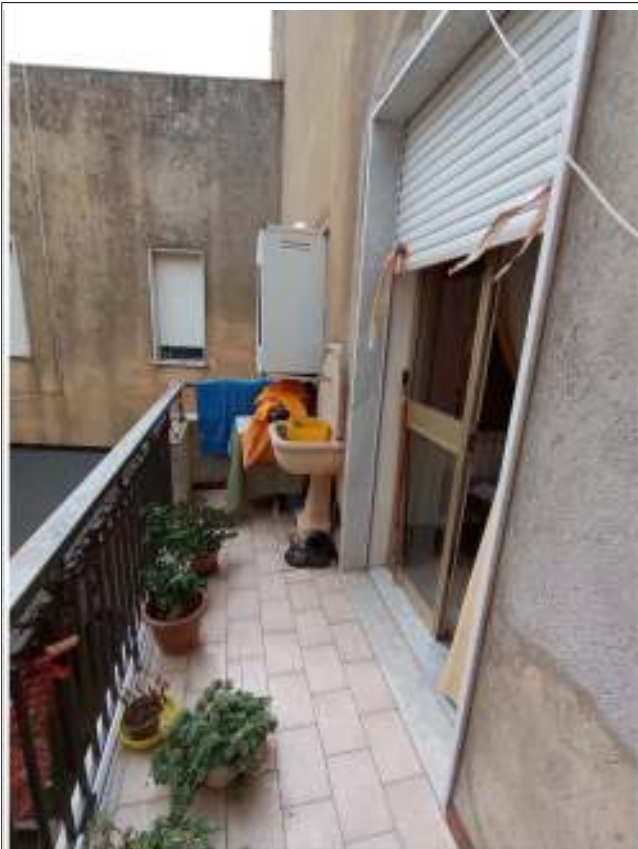
FOTO n° 27: Balcone interno abusivo
