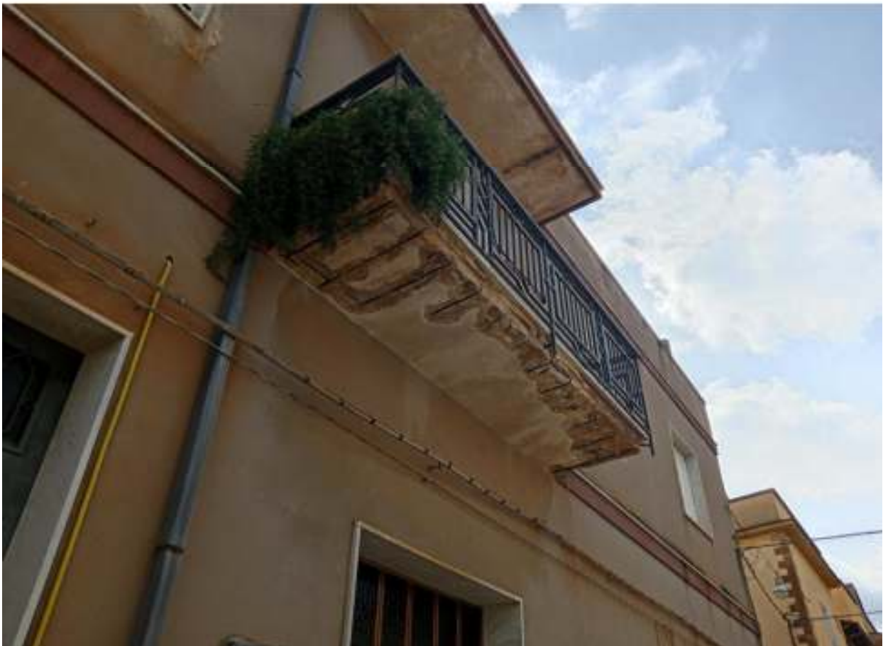
FOTO n° 24: Stato di manutenzione del balcone su Via dei Mille
