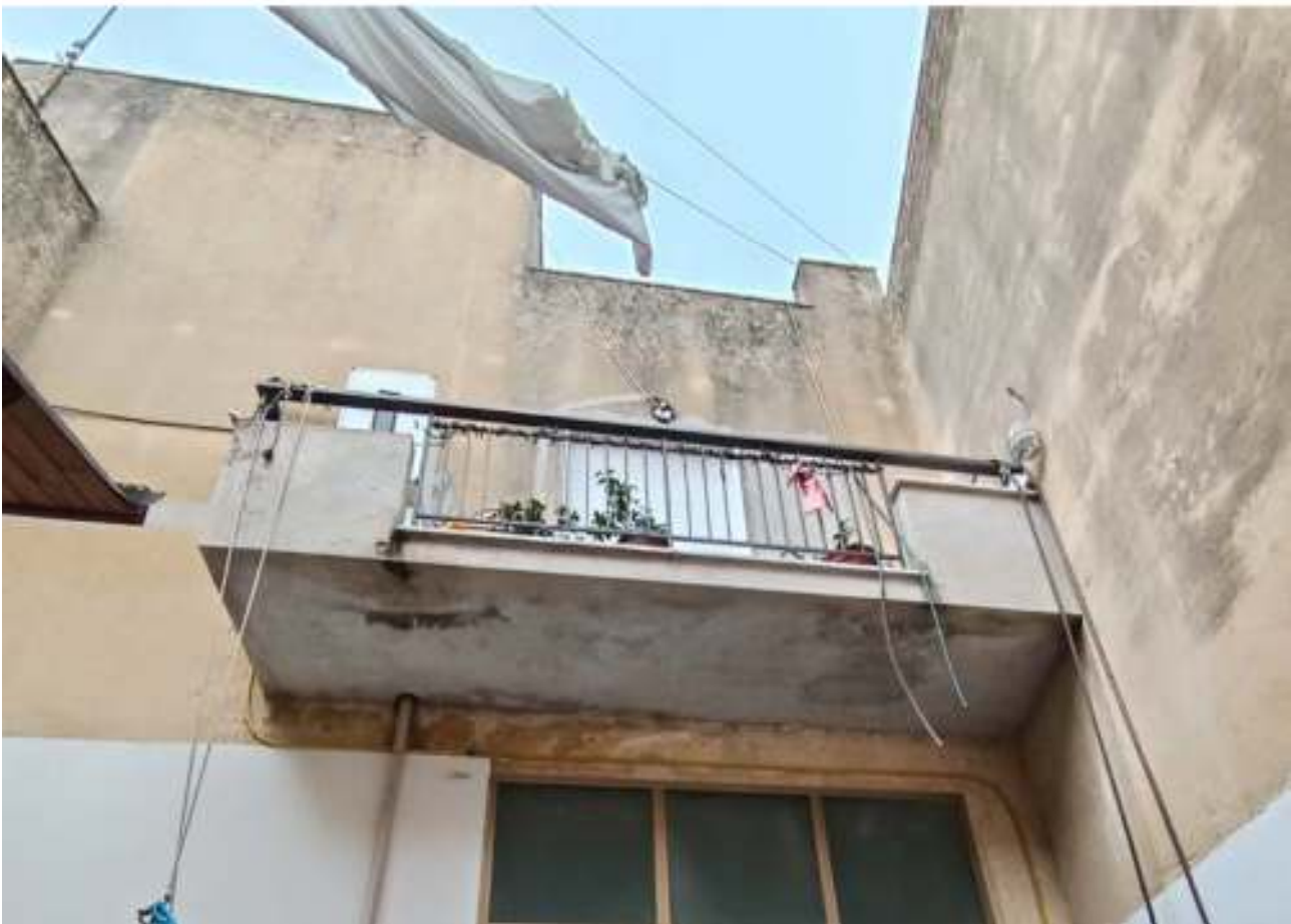
FOTO n° 26: Balcone interno abusivo
