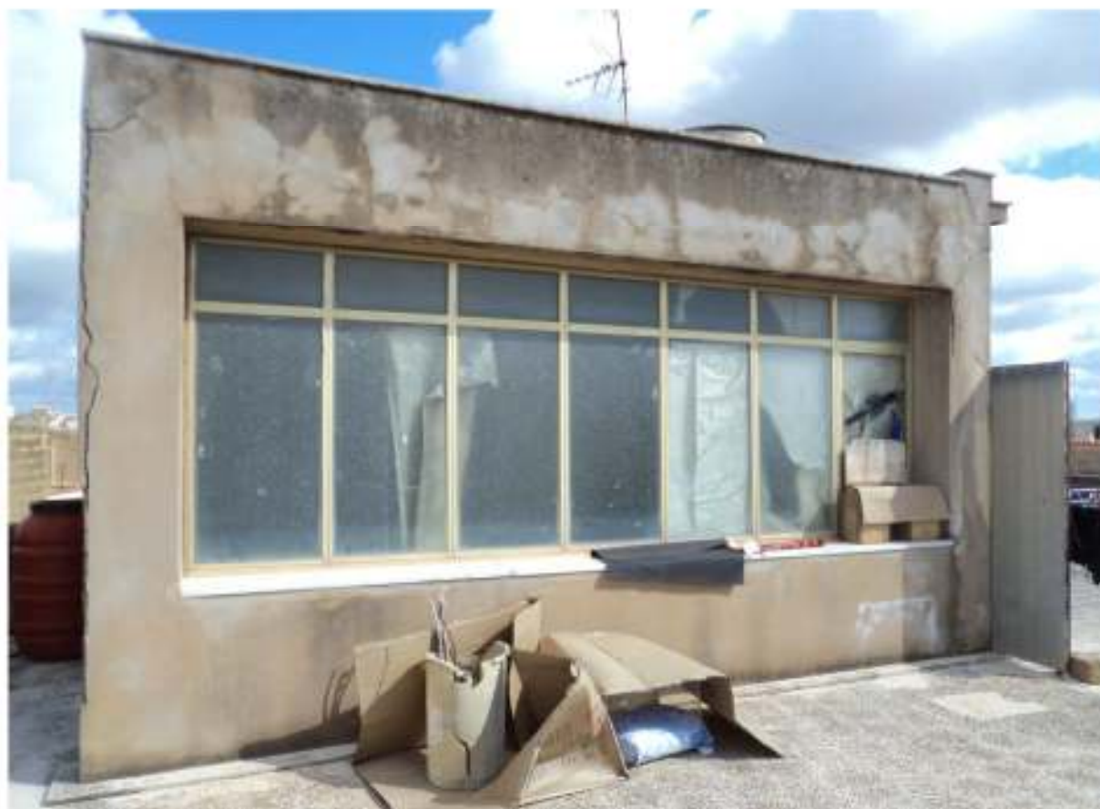
FOTO n° 22: Stato d'uso dei rivestimenti del torrino scala
