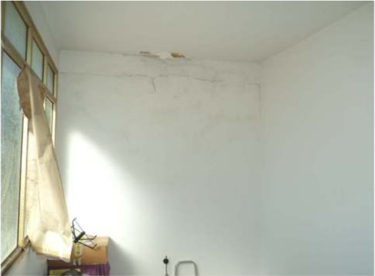
FOTO n° 23: Lesioni sugli intonaci interni del torrino scala
