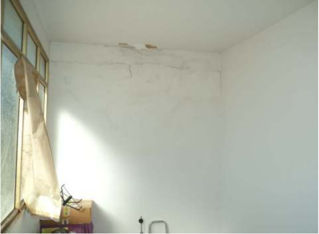
FOTO n° 22: Lesioni sugli intonaci interni del torrino scala
