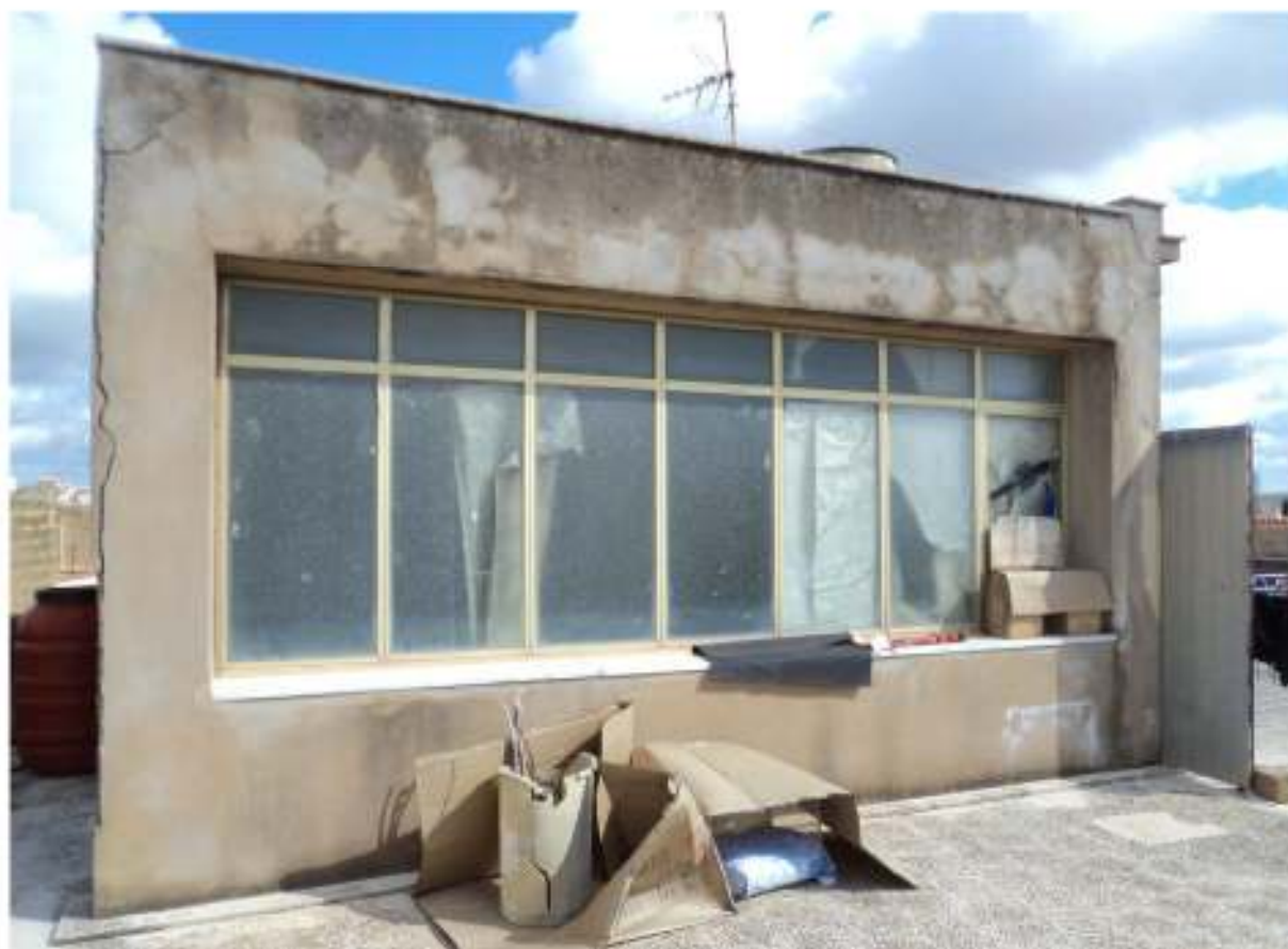
FOTO n° 21: Stato di fatto dei rivestimenti del torrino scala
