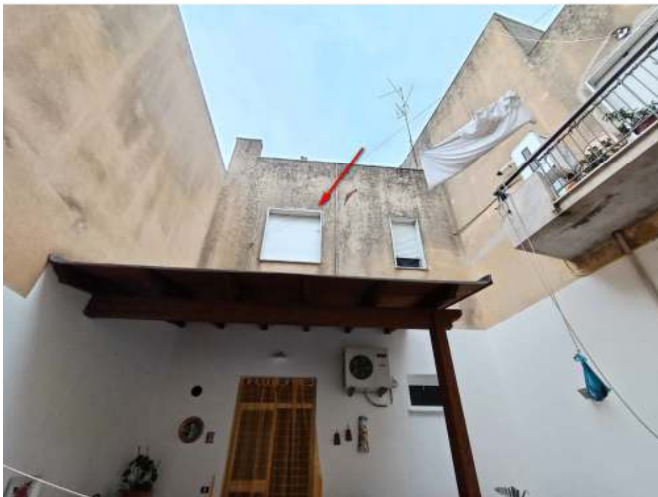
FOTO n° 28: Apertura esterna difforme al progetto
