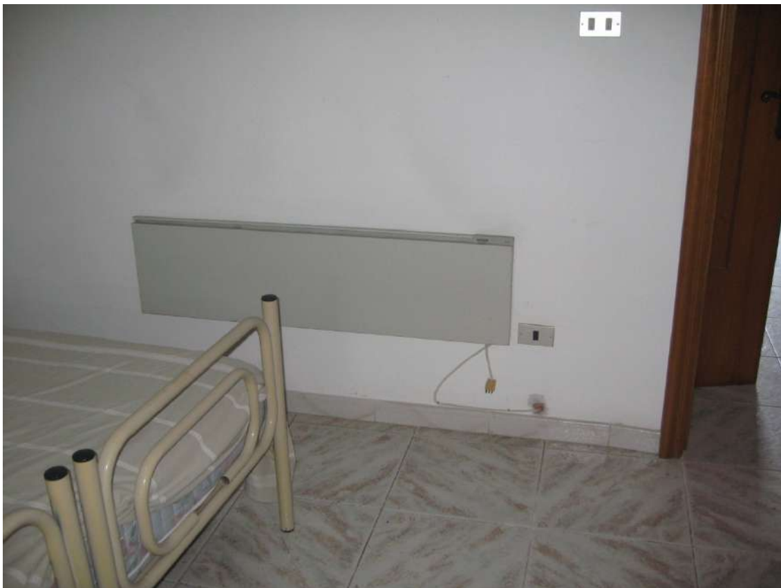
Foto n.13: sistema di riscaldamento ad alimentazione elettrica
