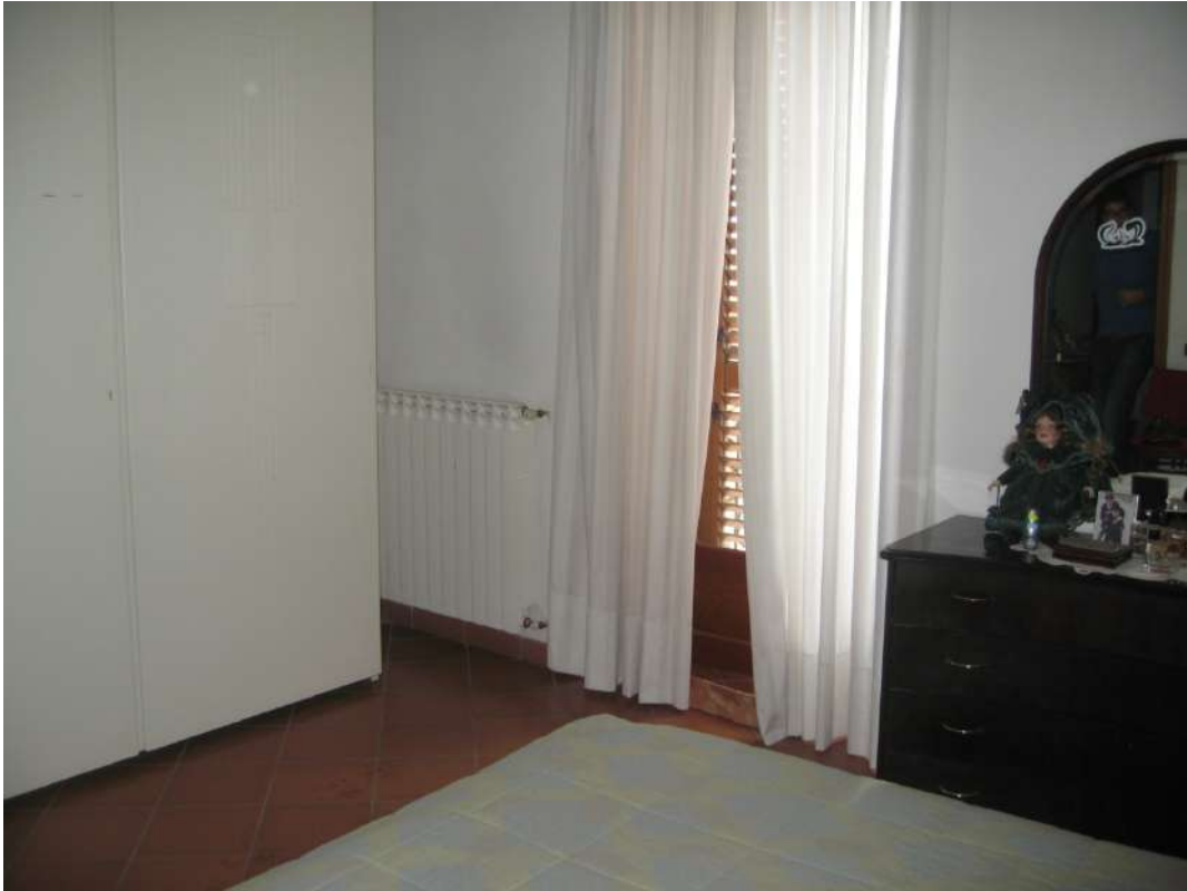
Foto n.29: porta finestra della camera n.2
