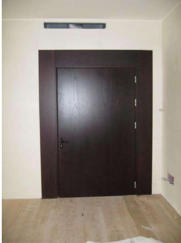
Foto n.26: immobile C. Vista porte interne. I compartimenti antincendio dell'immobile C sono ben definiti e le porte REI di separazione sono finemente rivestite in legno, come da foto.
