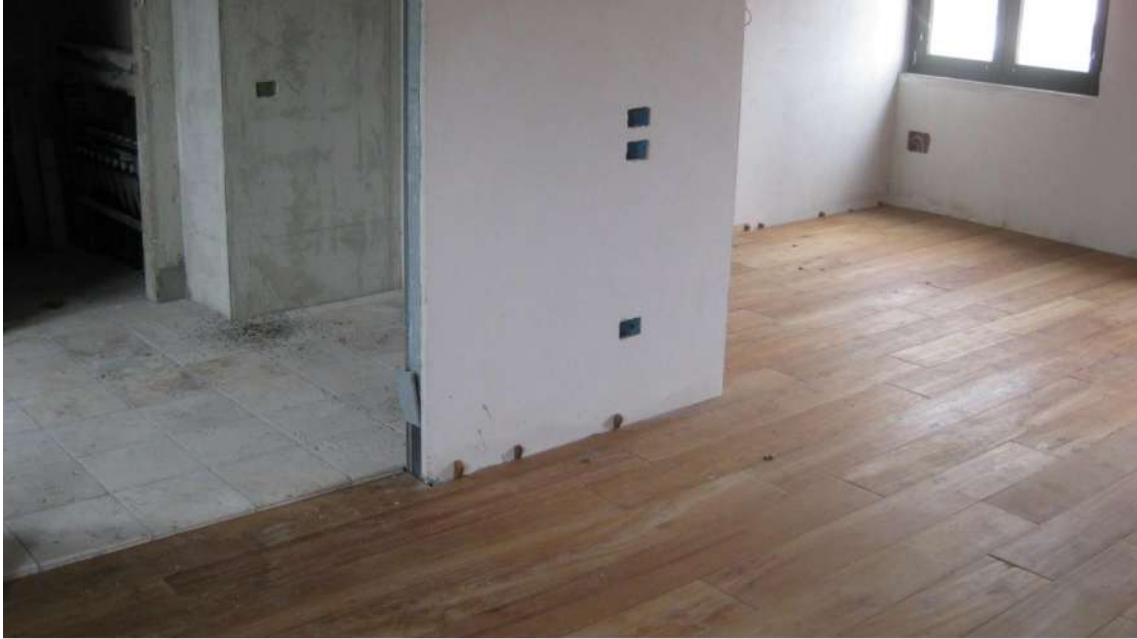
Foto n.17: rivestimento interno delle suite dell' immobile A, listoni di parquet nelle camere e ceramica negli ambienti bagno.
