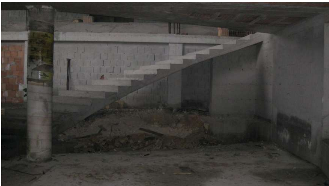
Foto n.46: vista dell'immobile D al livello più basso. La scala elicoidale panoramica è ubicata nella parte di edificio a doppia altezza.
