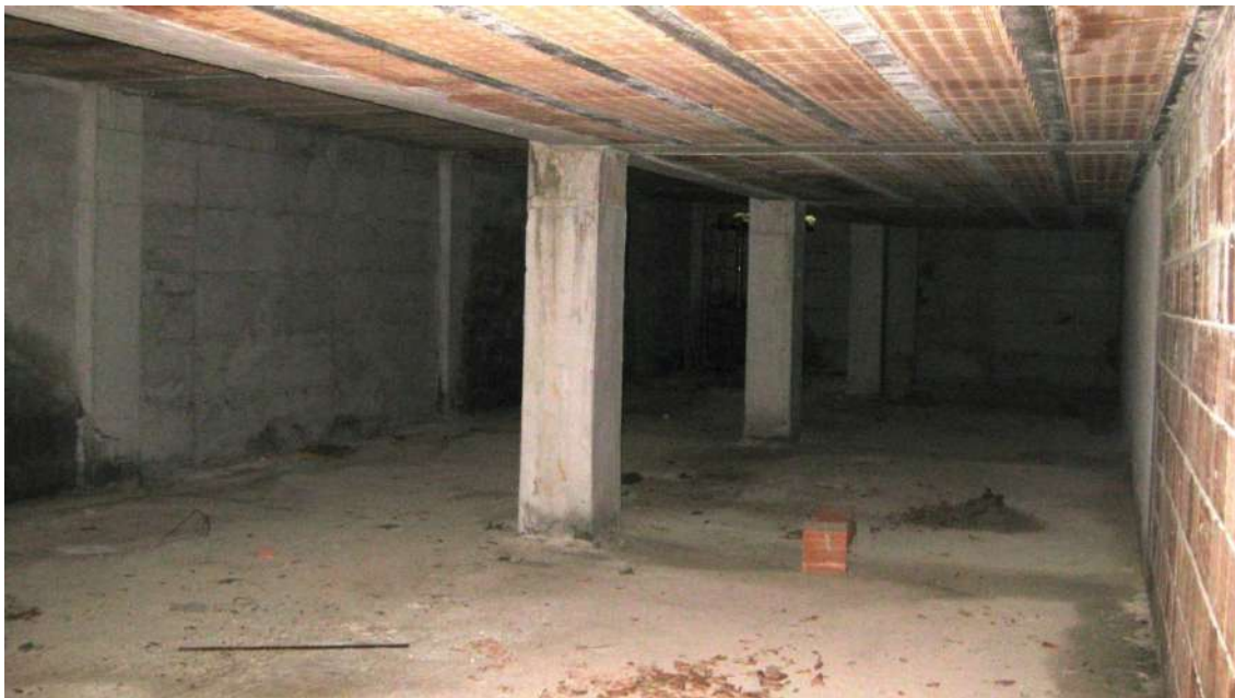
Foto n.48: vista dell'immobile D al livello più basso, vano tecnico
