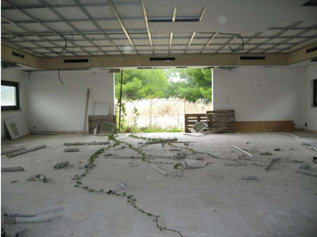
Foto n.31: Piano seminterrato . Sala ristorante dell'immobile C, con vista sul bosco circostante in direzione Nord-Est. La sala è ubicata nella parte di piano completamente fuori terra su tre lati. Mentre le cucine e i locali di servizio risultano totalmente interrati.
