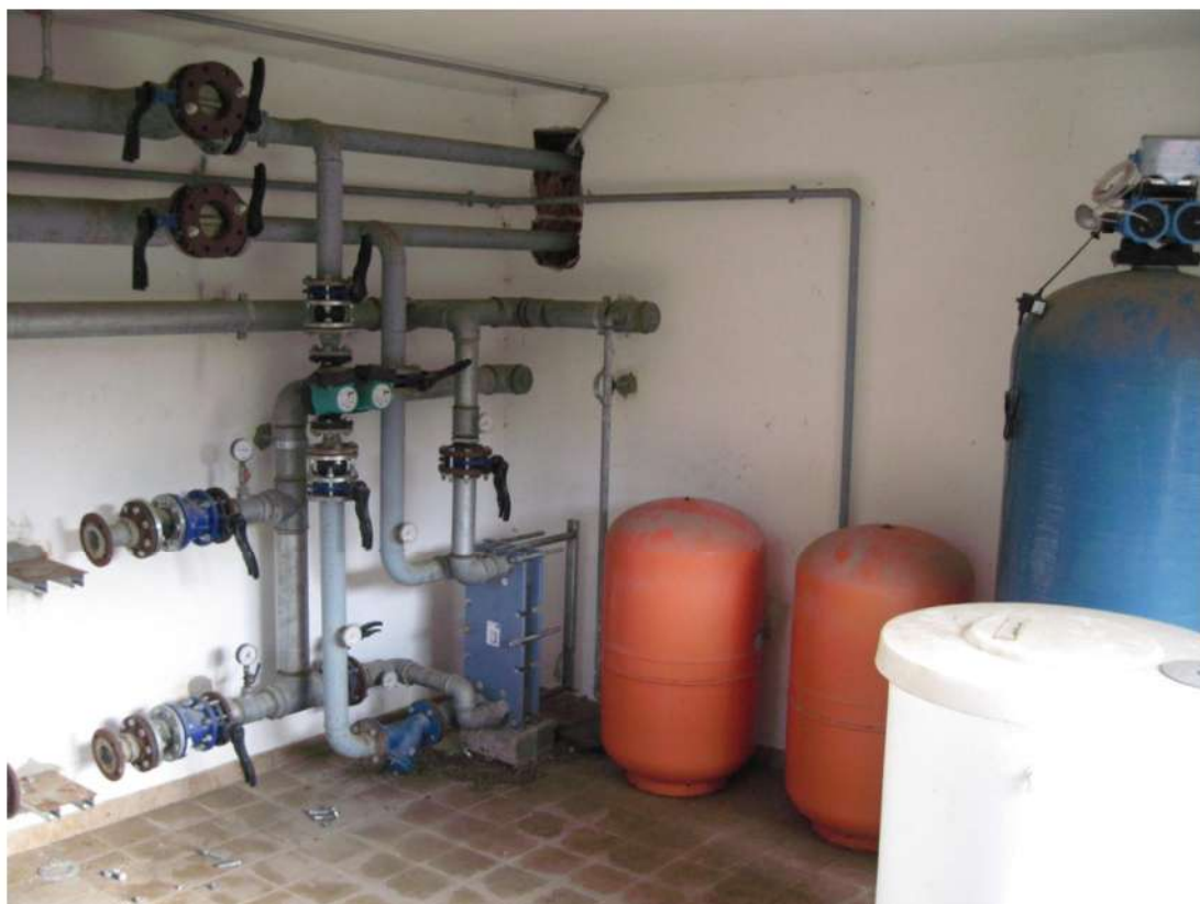
Foto n.51: interno dell'edificio adibito a vano tecnico
