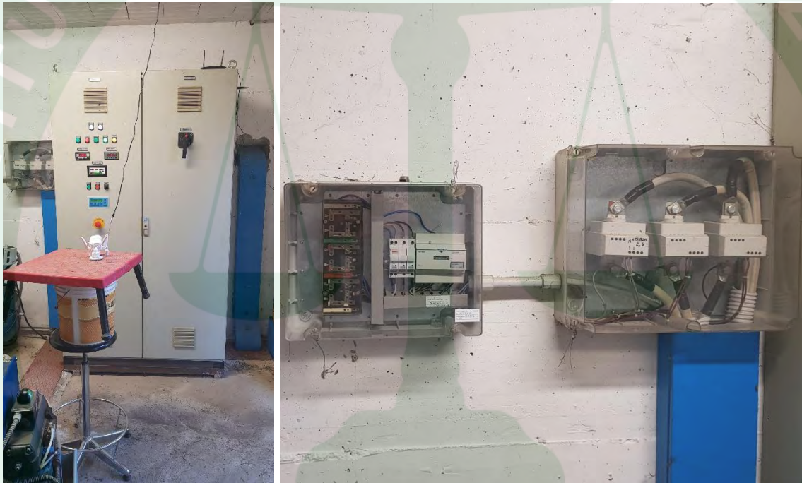
Figura 11 – Interno di centrale. Evidenza della necessità di interventi di manutenzione ordinaria
