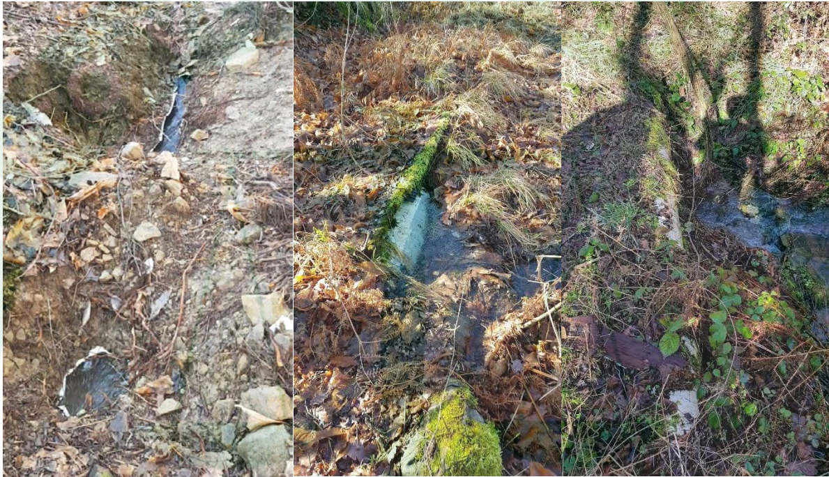
Figura 9 – Condotta di adduzione fortemente ammalorata con evidenti perdite di risorsa idrica lungo il suo tracciato che causano fenomeno di dilavamento ed erosione del versante
