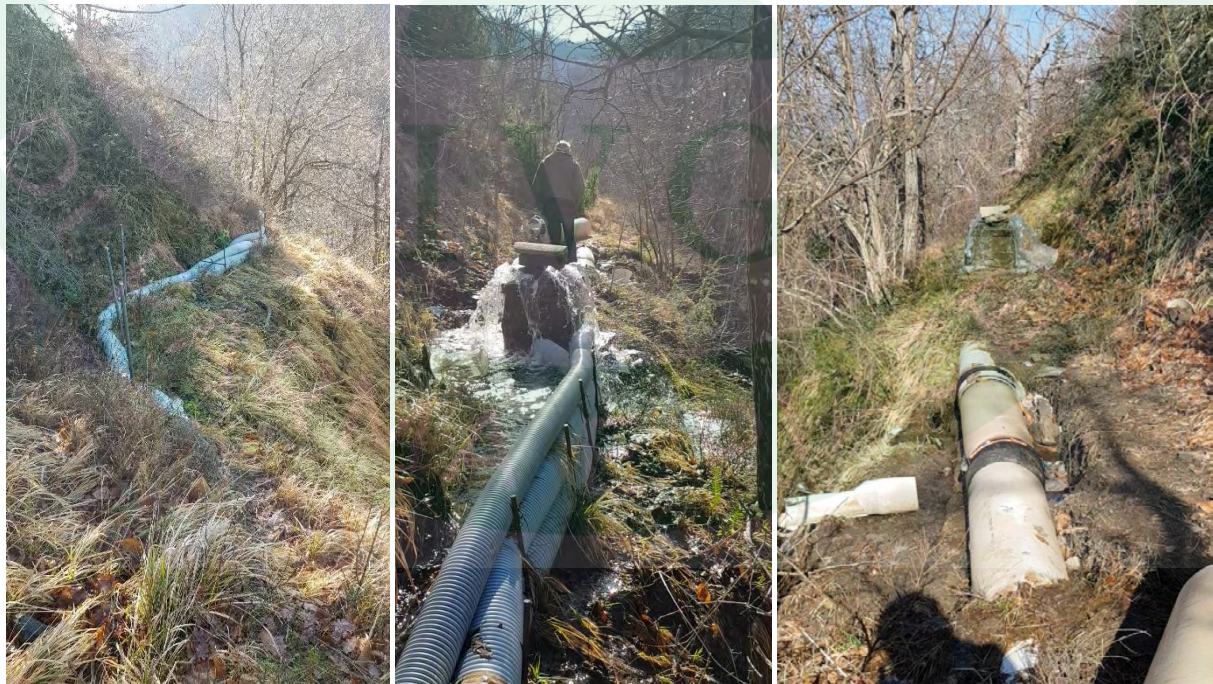
Figura 10 – Cospicue perdite idriche lungo la condotta di adduzione in corrispondenza di un pozzetto di giunzione che causano il dilavamento del versante
