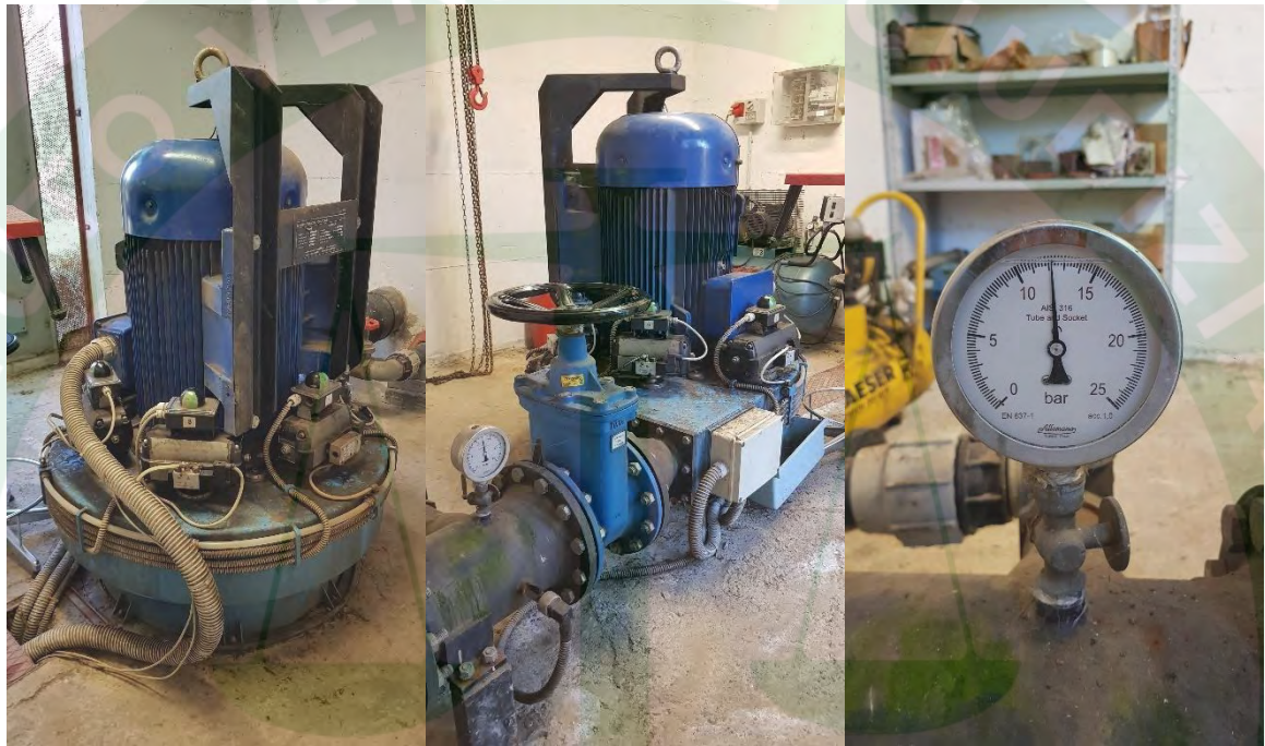
Figura 8 – Turbina idraulica e interno della centrale
