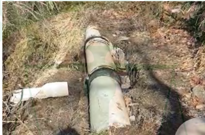
Figura 6 – Porzione di condotta non interrata che ha subito danneggiamento
