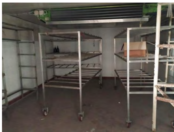
Interno della cella frigorifera
