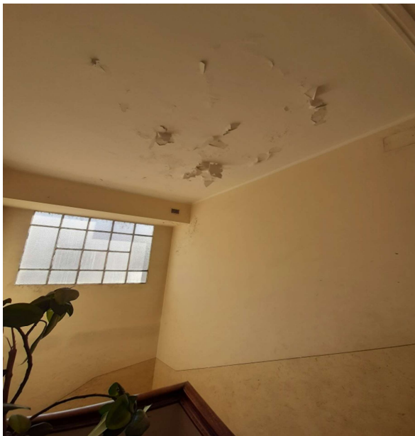
Segni di precedenti infiltrazioni nel soffitto del vano scale
