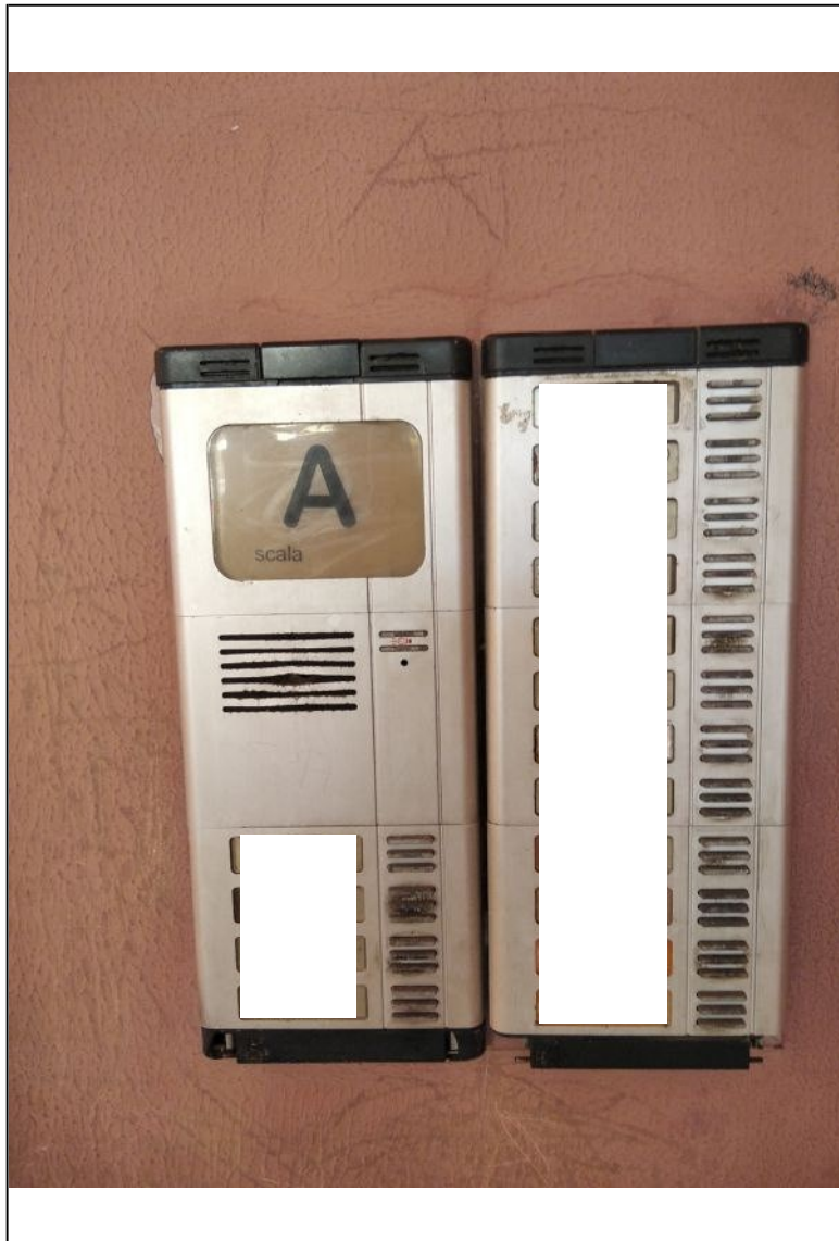
Foto n° 5. – Citofoni – Scala A
