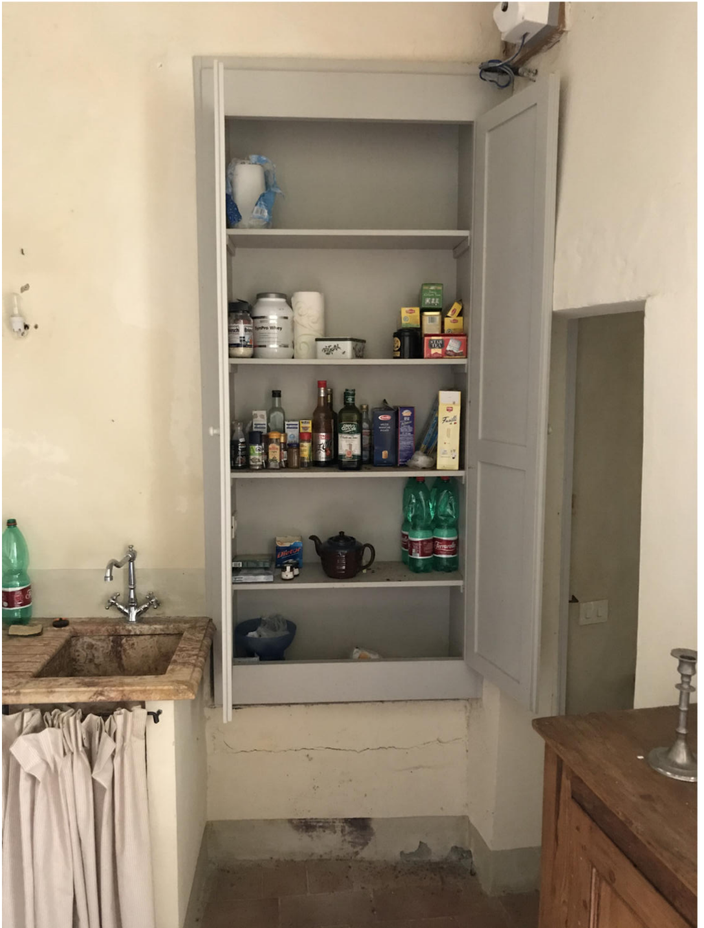
Vista dell'armadio a muro installato sul vano della ex porta d'ingresso civ. 1
