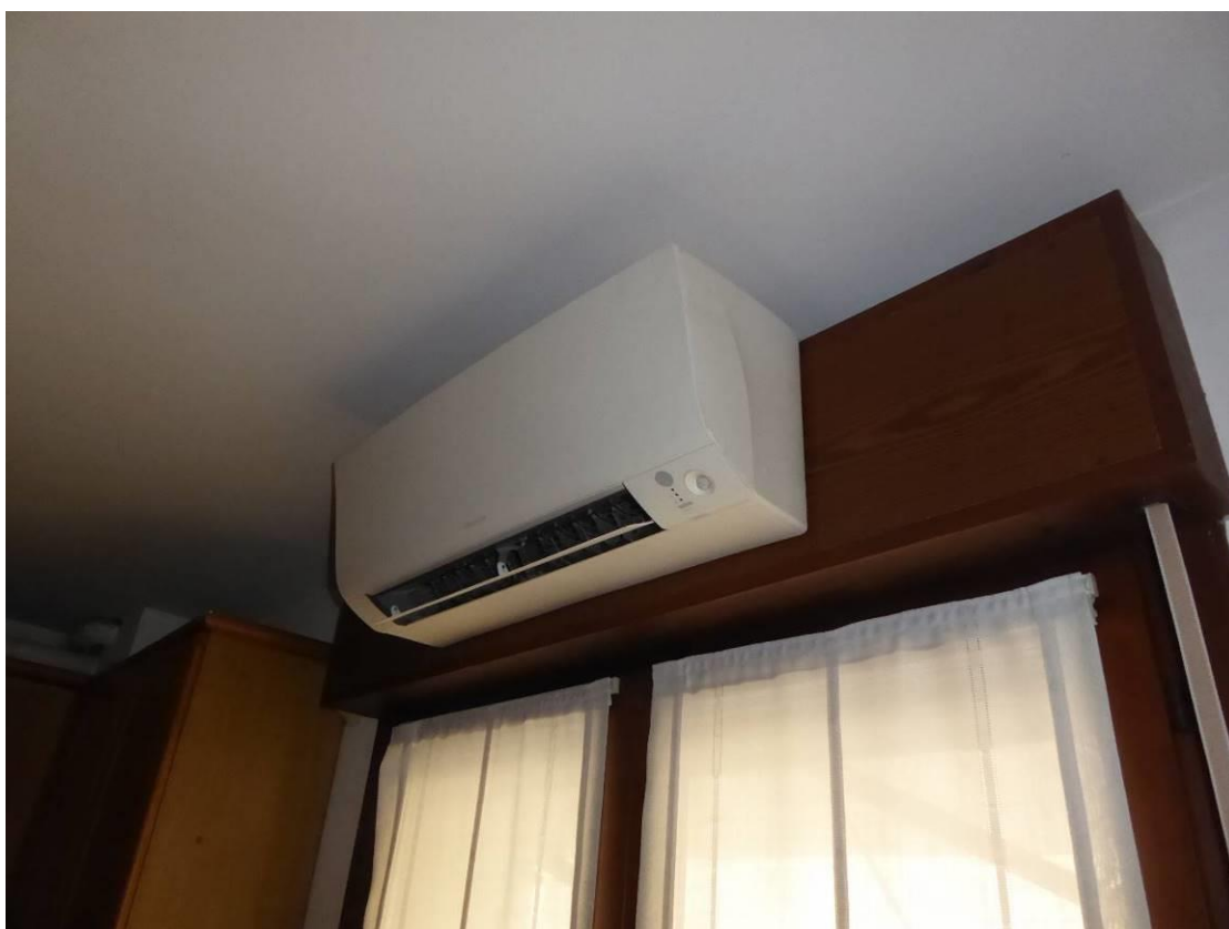
Foto 18 – split impianto climatizzazione
