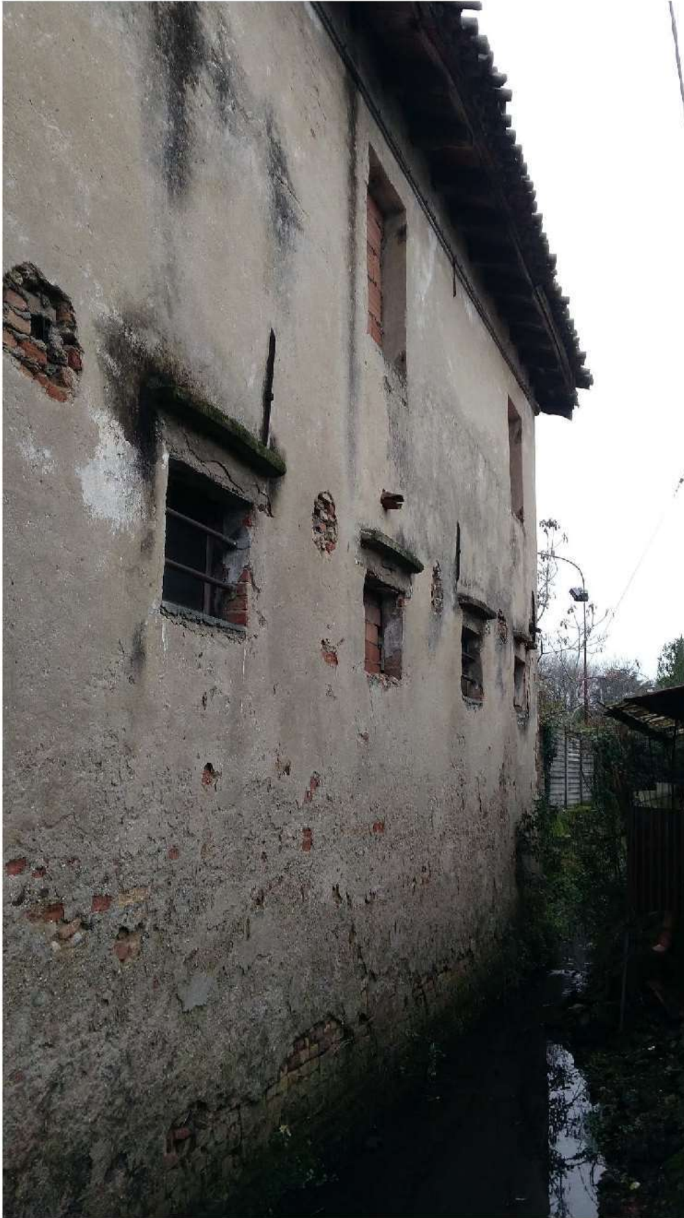
DETTAGLIO DELLA MURATURA LATO NORD DELLA PORZIONE "ALTA", CON LA PARTE PERICOLANTE DELLA CORNICE DI GRONDA. LE PUNTELLAZIONI PREVISTE ARRIVANO FINO ALLA FINESTRA IN CENTRO IN ALTO
