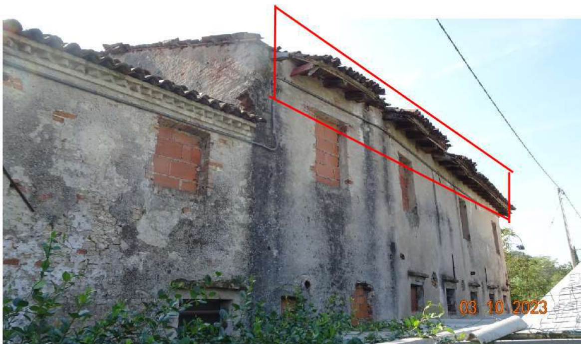
Elementi copertura in coppo pericolanti verso il fossato e verso la confinante proprietà.
