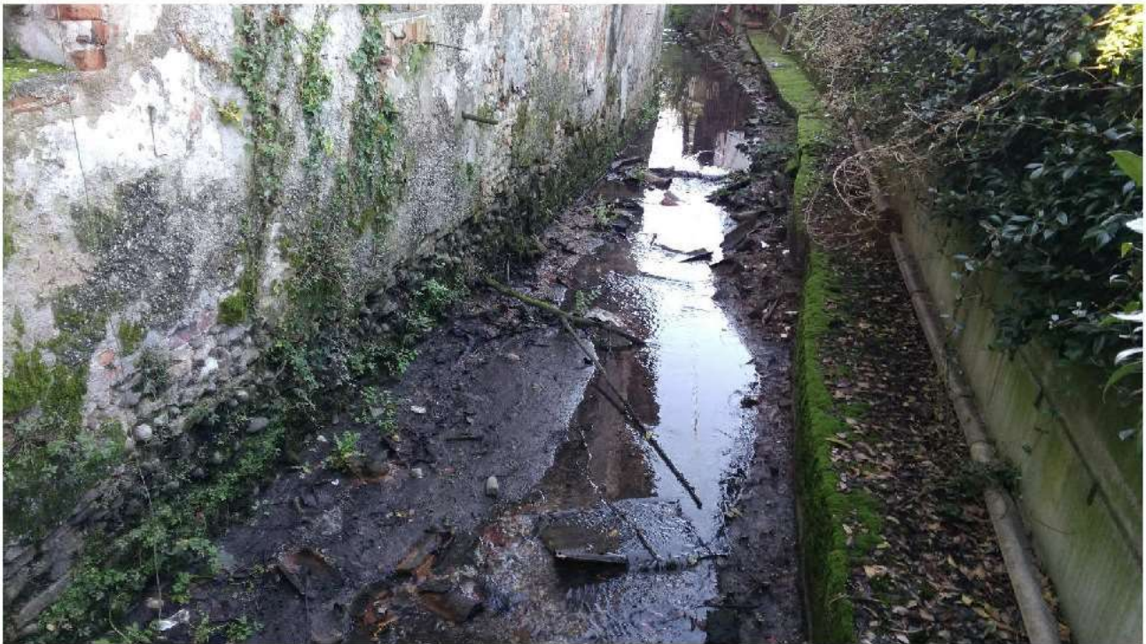
VISTA DEL FOSSATO LATO NORD, DELLA MURATURA DELLA PORZIONE "BASSA", DELLE RECINZIONI DELLE PROPRIETA' CONFINANTI E DEL RELATIVO BASAMENTO DI FONDAZIONE (con cavo elettrico entro canaletta) SUL QUALE SARANNO IMPOSTATE LE PUNTELLAZIONI PREVISTE
