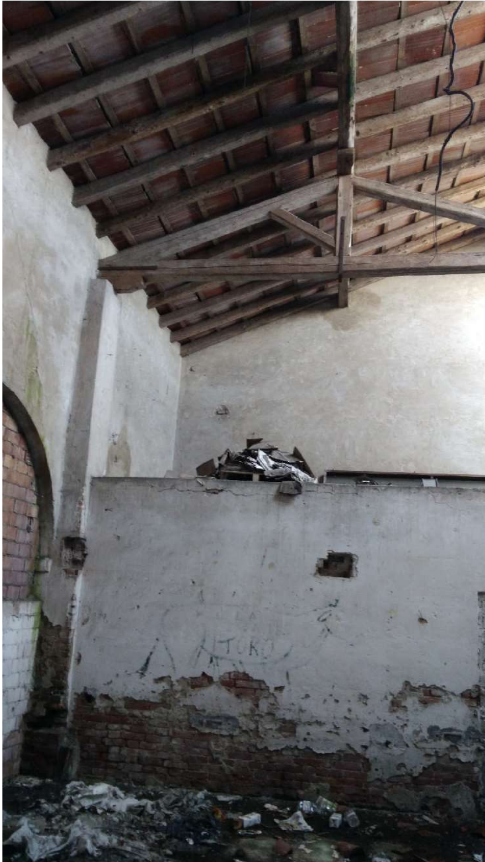
PARETE NORD DEL LOCALE "F", CON IL MURO CHE DELIMITA L'ADIACENTE LOCALE "E" E LA SOPRASTANTE PORZIONE INTEGRA DELLA COPERTURA. VISIBILE L'ARCO TAMPONATO SUL LATO SUD
