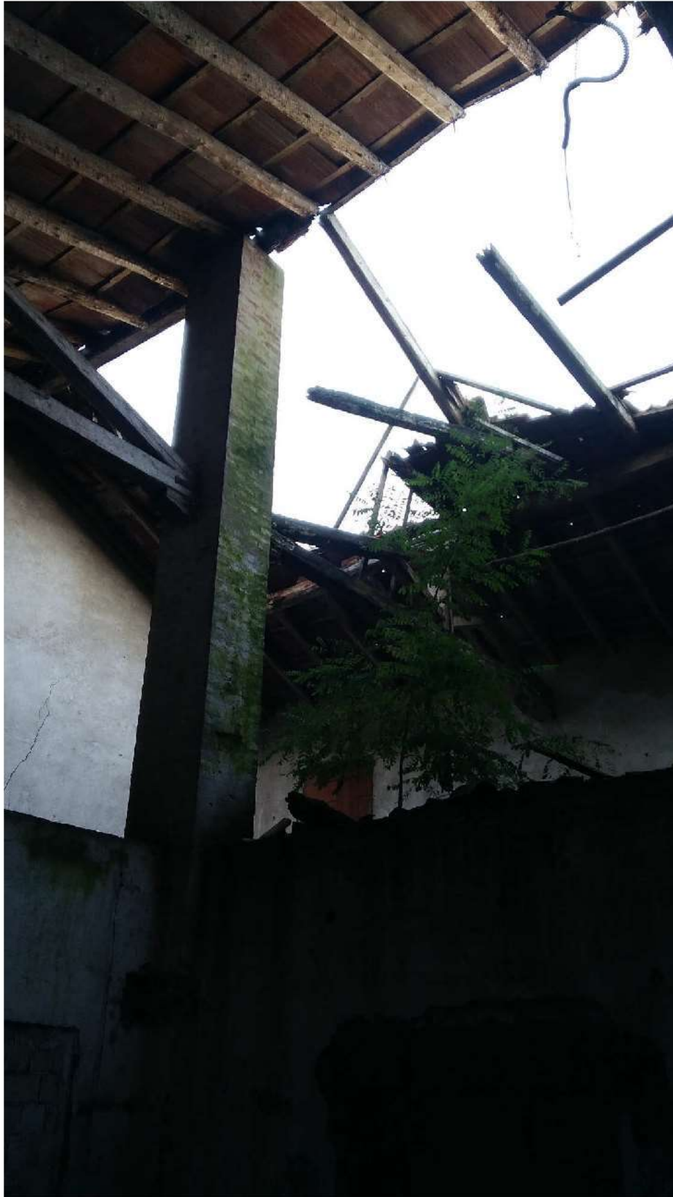
VISTA DALL'INTERNO DEL LOCALE "F" DI PARTE DELLA COPERTURA CROLLATA SUL SOLAIO DEL LOCALE "A" (zona ovest) VISIBILI DUE CAPRIATE DI SOSTEGNO DELLE TRAVI INTERMEDIE DI ROMPITRATTA
