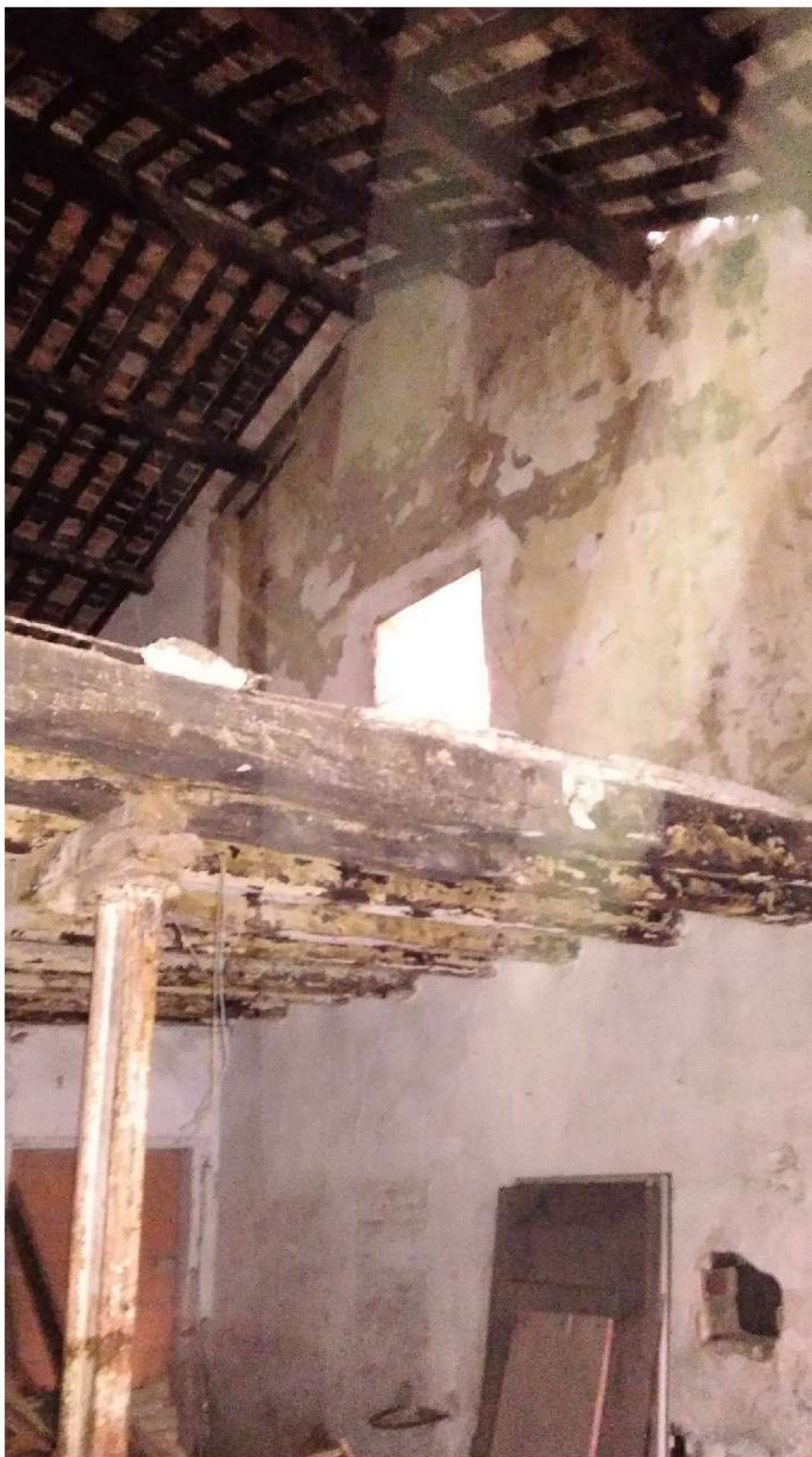
INTERNO DEL LOCALE "C", CON VISTA DELLA TESTA DEL SOLAIO INTERMEDIO, DELLA COLONNA METALLICA DI SOSTEGNO DELLA TRAVE DI ROMPITRATTA E DELLA COPERTURA ORIGINARIA AVENTE ORDITURA DELLE TRAVI "ALLA VICENTINA" CON MORALI E TAVELLE PIENE IN LATERIZIO (con piccola porzione della falda nord in stato precario, a ridosso della muratura, si vede la luce esterna)
