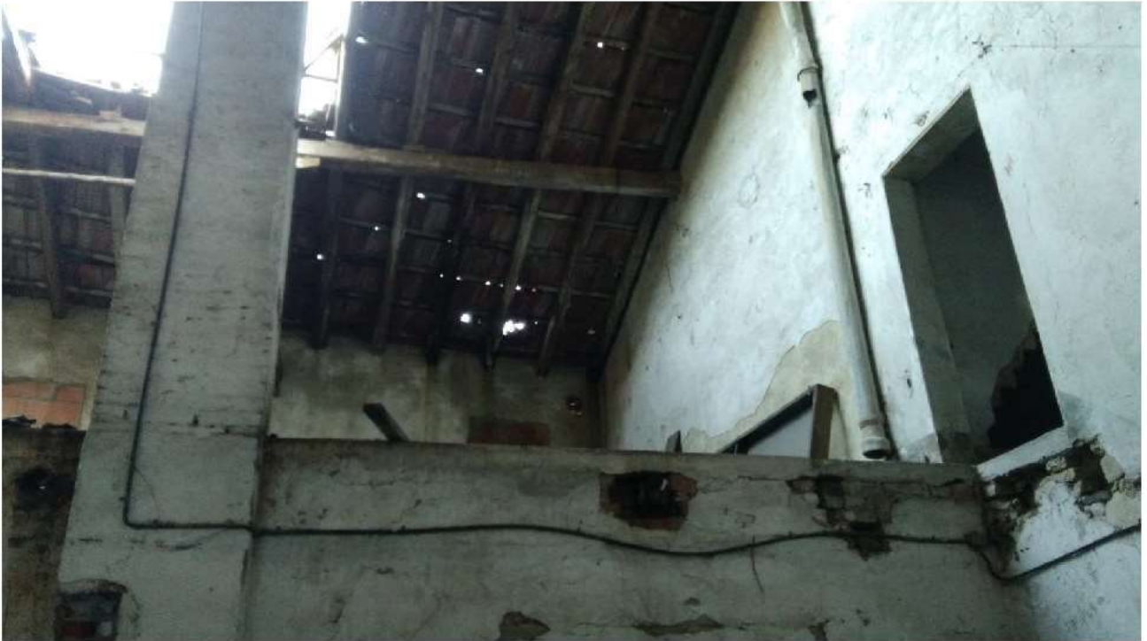
VISTA DALL'INTERNO DEL LOCALE "F" DI PARTE DELLA COPERTURA CROLLATA SUL SOLAIO INTERMEDIO DEL SOTTOSTANTE LOCALE "A" (zona est della falda nord)
