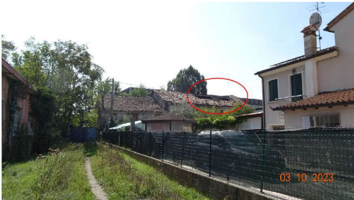
Copertura implosa verso l'interno.
