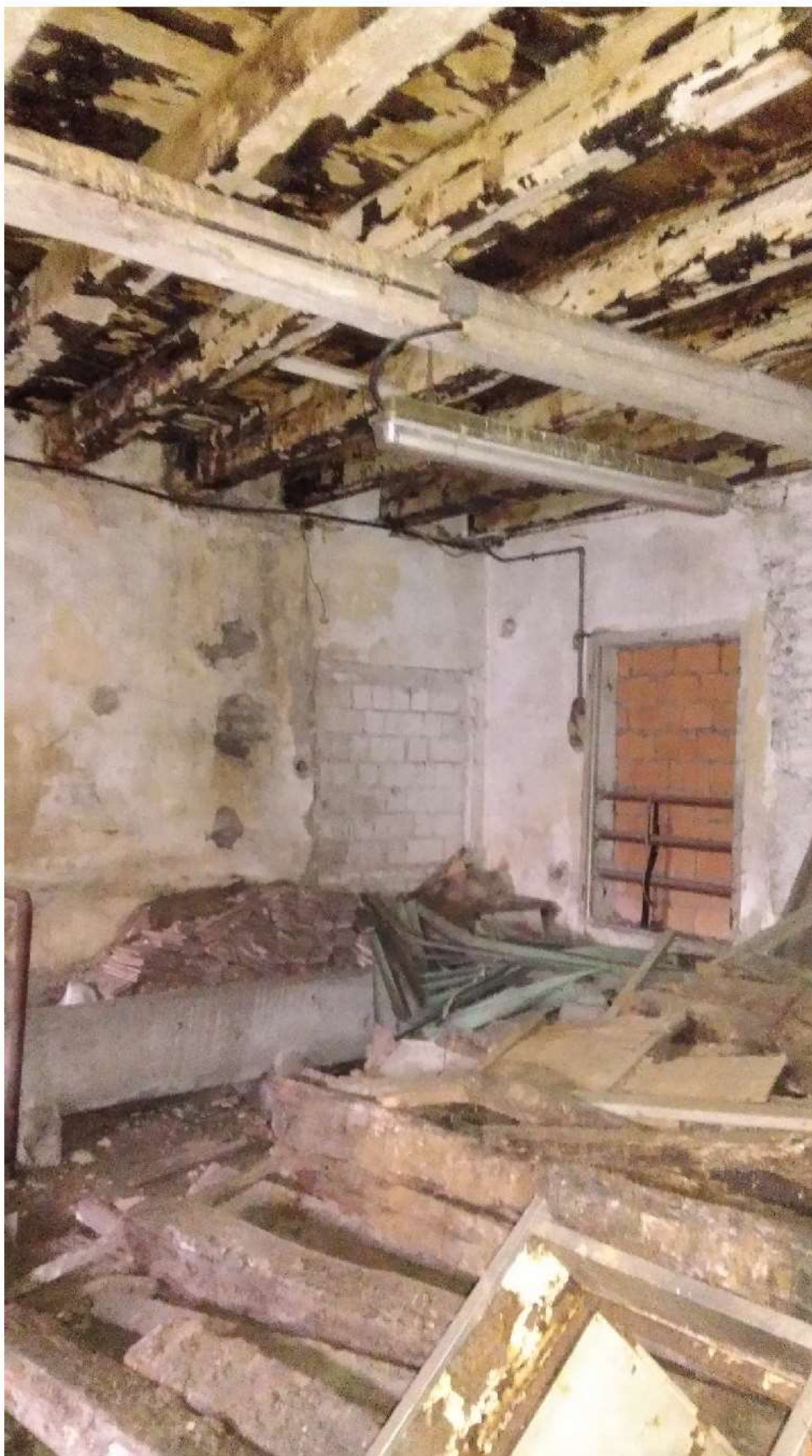
INTERNO DEL LOCALE "C", ANGOLO SUD EST, ZONA CON IL SOLAIO INTERMEDIO (molto ammalorato) E RELATIVA TRAVE DI ROMPITRATTA
