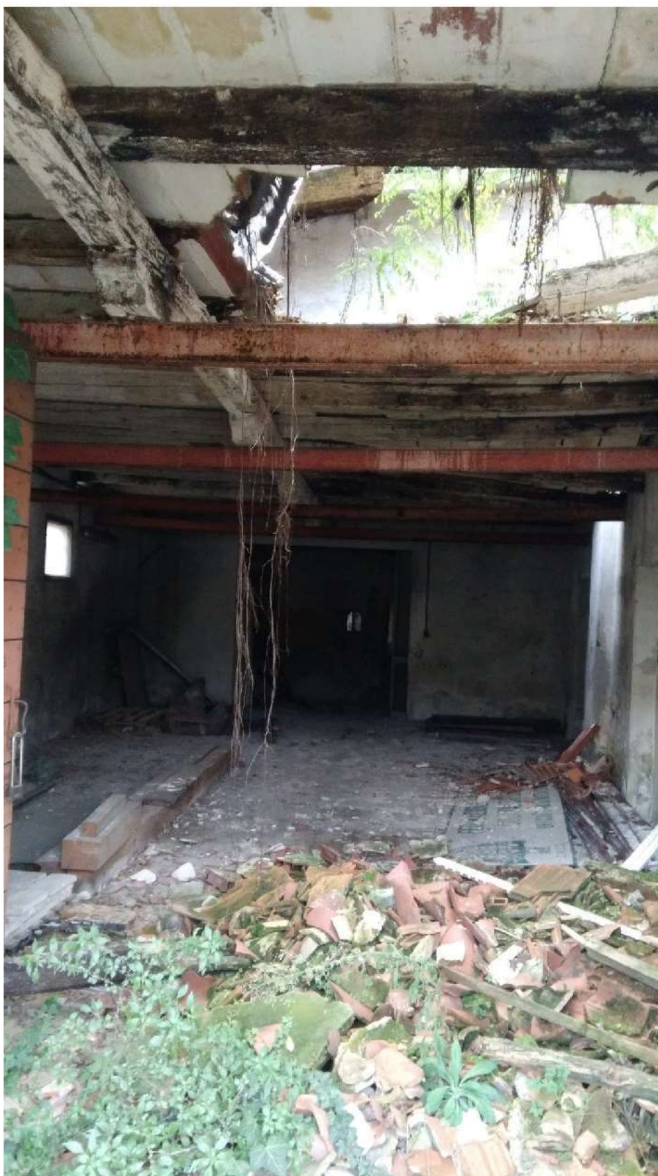
LOCALE "A" – PIANO TERRA, CON DETTAGLIO DELLA PORZIONE CROLLATA DEL SOLAIO INTERMEDIO IN PROSSIMITA' DELL'INGRESSO SUL LATO OVEST E LE RELATIVE MACERIE. LE PUTRELLE IN ACCIAIO
