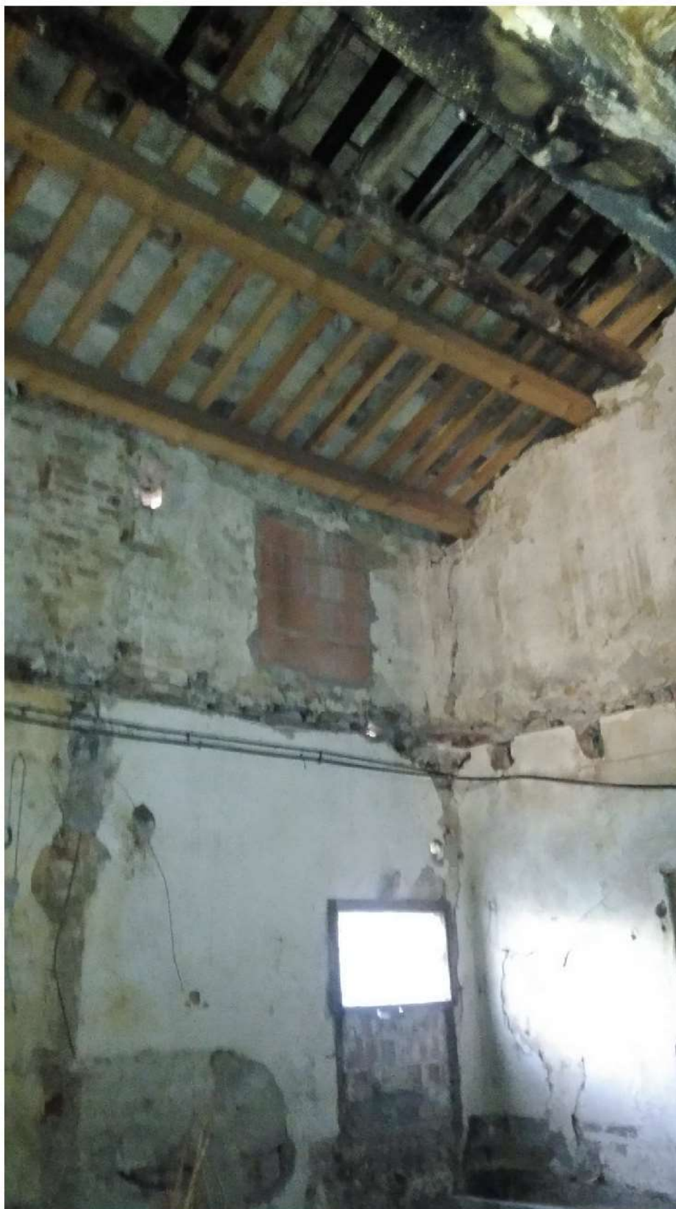
INTERNO DEL LOCALE "C" (angolo nord/est) VISIBILE PARTE DELLA COPERTURA RIFATTA E PARTE DELLA COPERTURA ORIGINARIA PIU' SCURA, AMMALORATA DA MUFFE E DA UN PROBABILE INCENDIO
